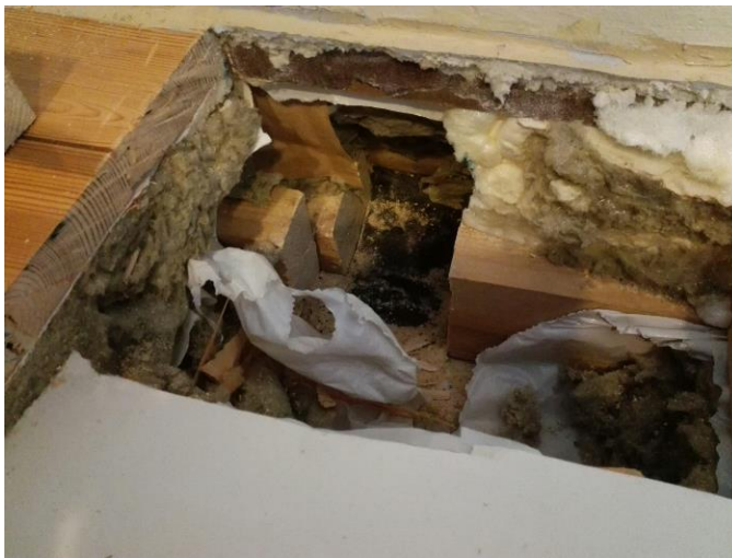
Kuva 4 Olohuoneen lattia avattuna (Kuntotarkastajan raportti)
