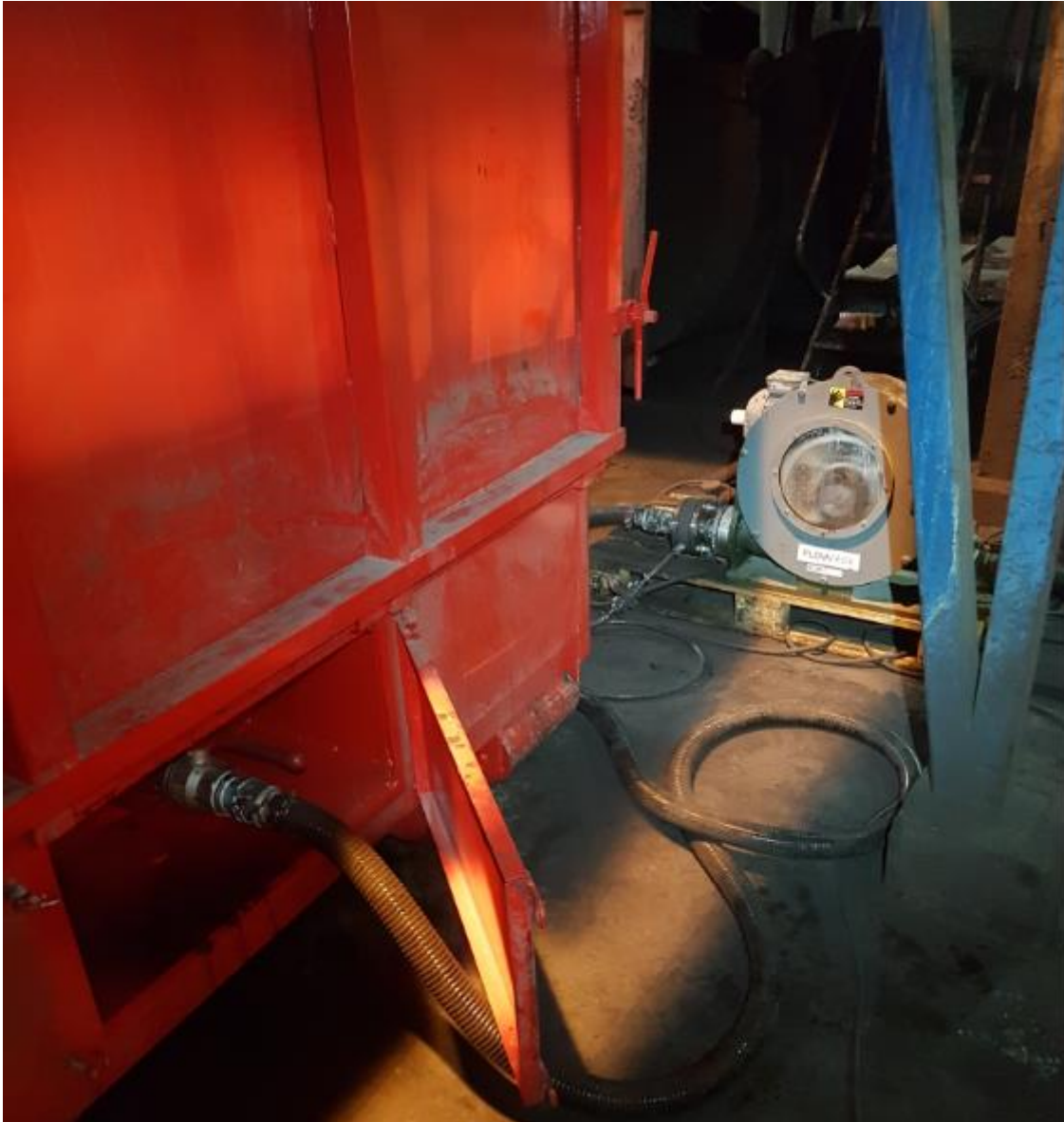
KUVA 15. Suodosveden pumppaus takaisin
