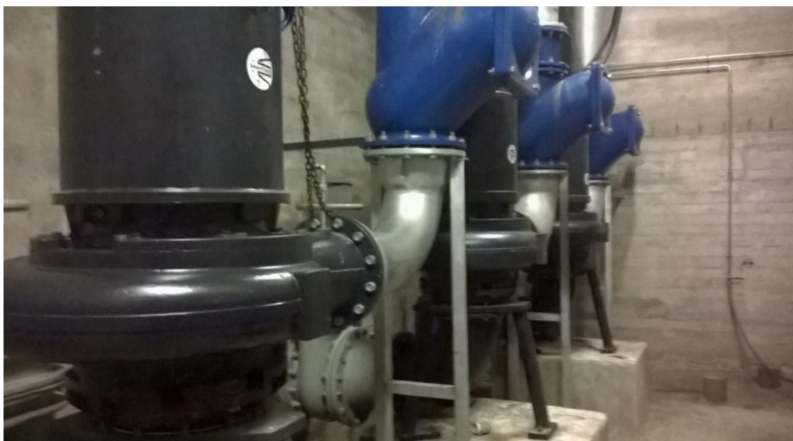
Figur 18. Östra hamnens pumpstations pumprum.
