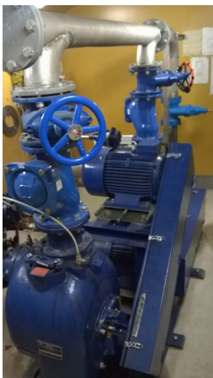
Figur 25. Insidan av Ceders pumpstation är två pumpar är torruppställda.
