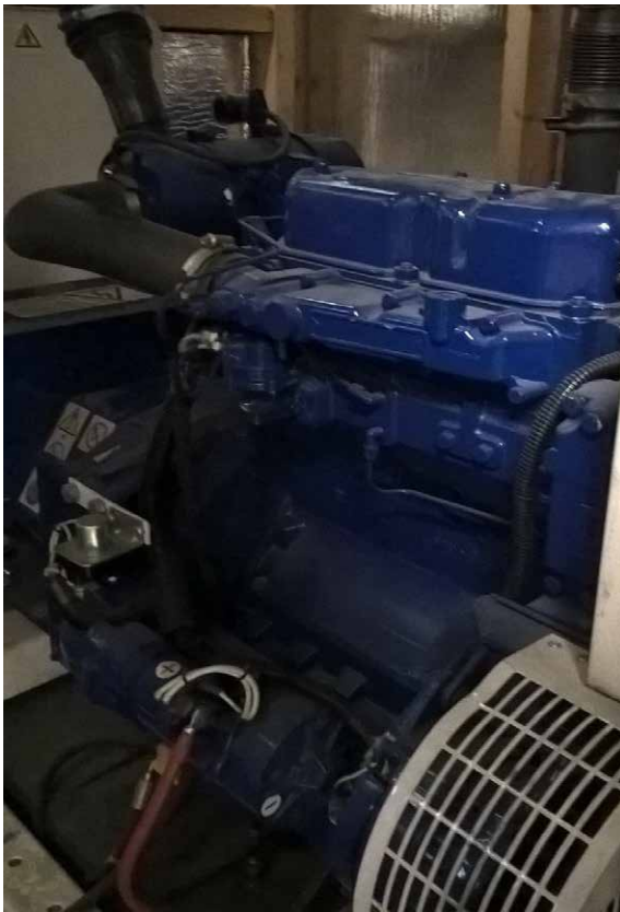
Kuva 7. Dieselgeneraattori Xamkin energiatekniikan laboratoriossa. Kuva. Xamk.
