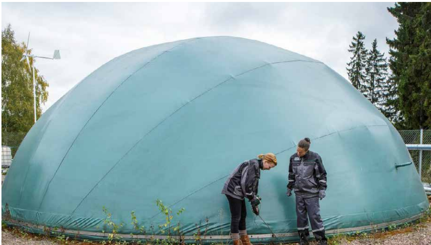
Kuva 23. BioSammossa sijaitseva biokaasuprosessin mädätysyksikkö. Kuva. KSAO.
