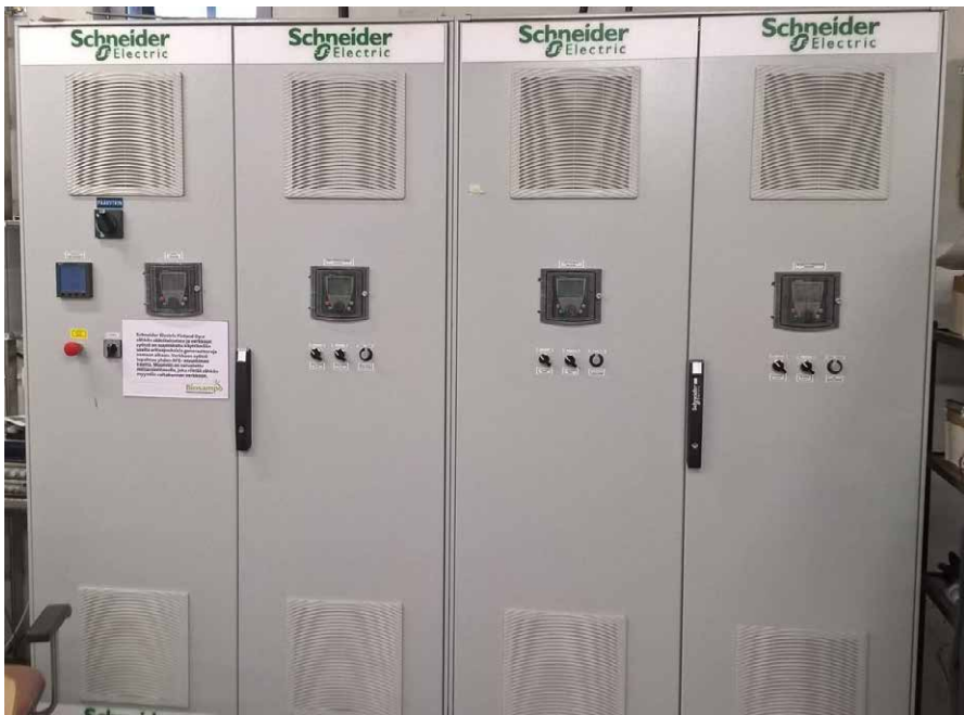
Kuva 30. Schneider, sähkön verkkosyöttöjärjestelmä BioSammossa. Kuva. Xamk.
