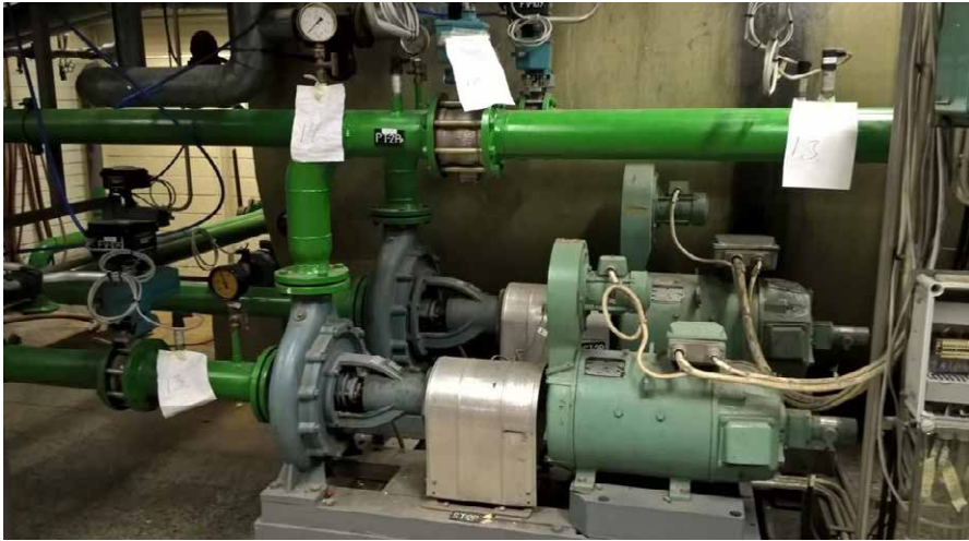
Kuva 6. Pumppu- ja putkistokoneikko Xamkin energiatekniikan laboratoriossa. Kuva. Xamk.
