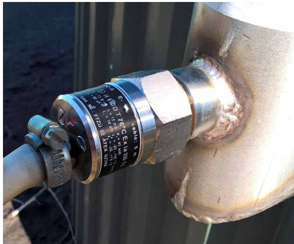
Kuva 4. Todellinen näkymä biokaasuprosessin komponentista - reaktorin varoventtiili, jälkikaasusäiliö. Kuva. Xamk.
