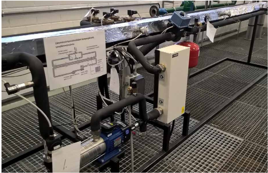
Kuva 4. Lämmönsiirrin Xamkin energiatekniikan laboratoriossa. Kuva. Xamk.
