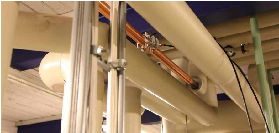
Kuva 17. Ultraääneen perustuva nesteenvirtausmittari asennettuna putken pinnalle Xamkin asiakaskohteessa. Kuva. Xamk.
