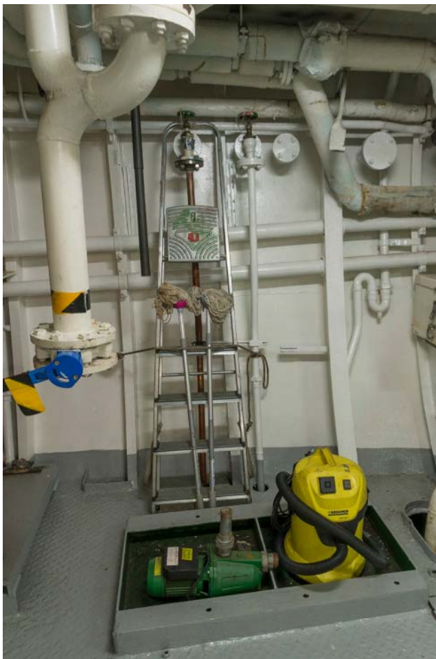
Figur 19. Evaporatorns gamla stativ och HT-vattenrör
