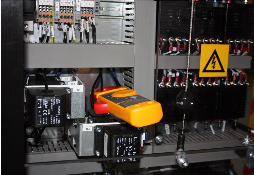
KUVA 27. Vaiheiden virran mittaus pihtimittarilla
