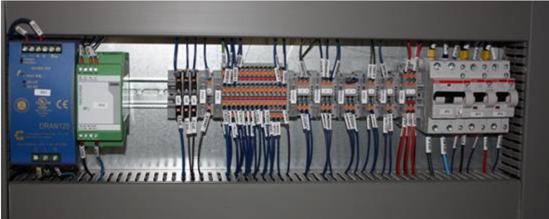
KUVA 8. Teholähteet, 2X24-riviliittimet, yhdistelmäsuoja ja yksivaihesulakkeet
