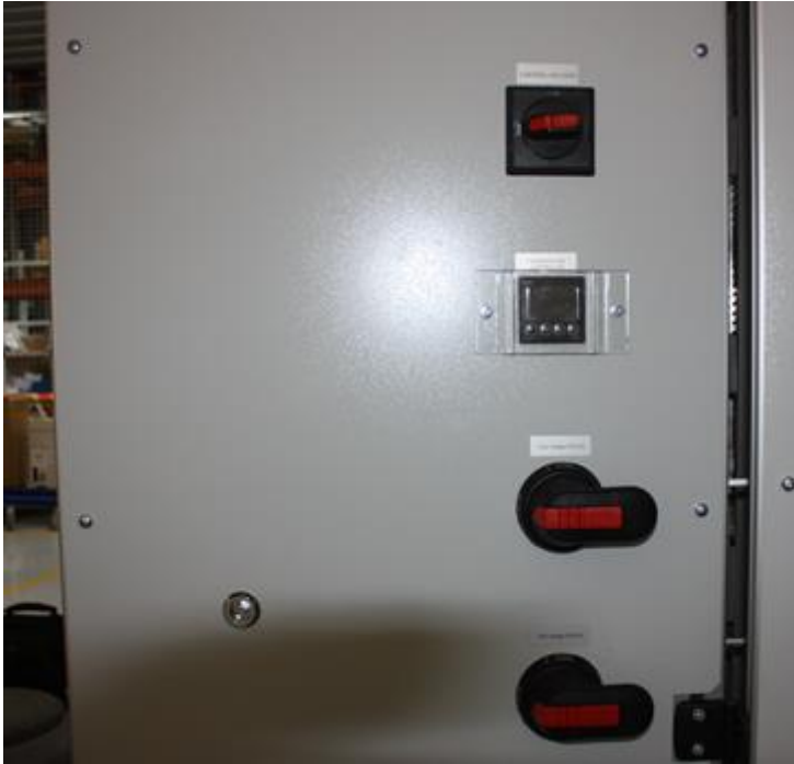
KUVA 9. Pääkytkin ja testijännitekytkimet
