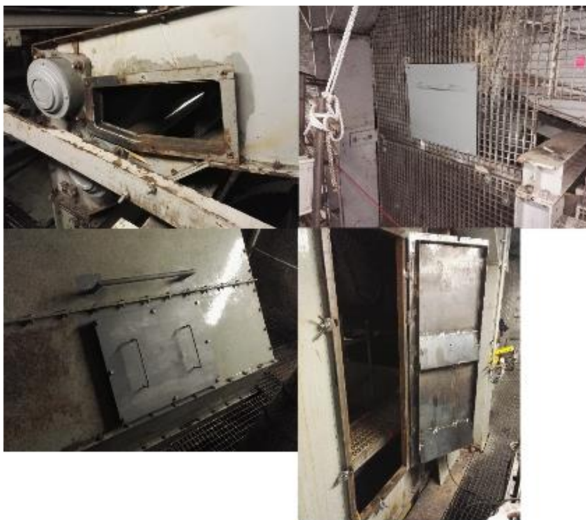
Kuva 34. Kuljettimien uudet tarkistusluukut.
