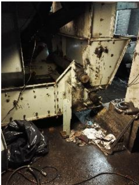
Kuva 19. Taittoakselit valmiina vaihdettavaksi.
