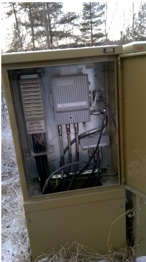
Kuva 19. Vuotavan jakamon laitteita.
