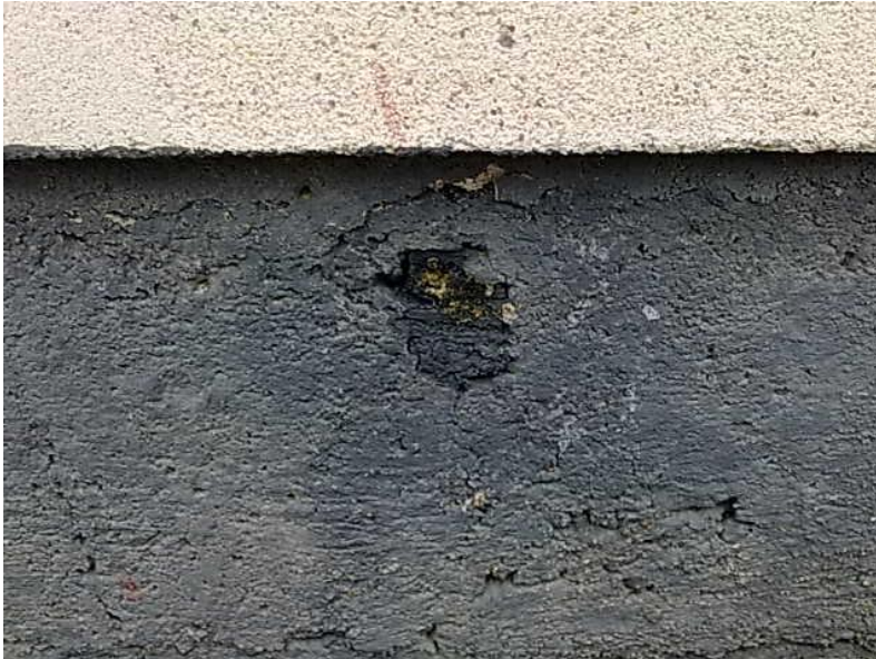
KUVA 4. Sokkelivalun sisään jätetty valumuotin tukiosa
