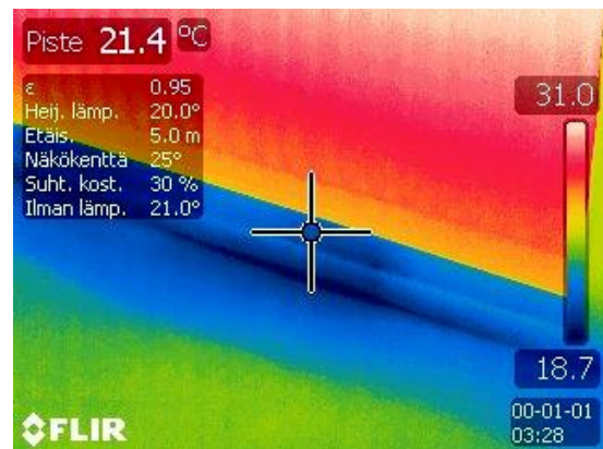
KUVA 36. Kuvan 35 kohta lämpökameralla
