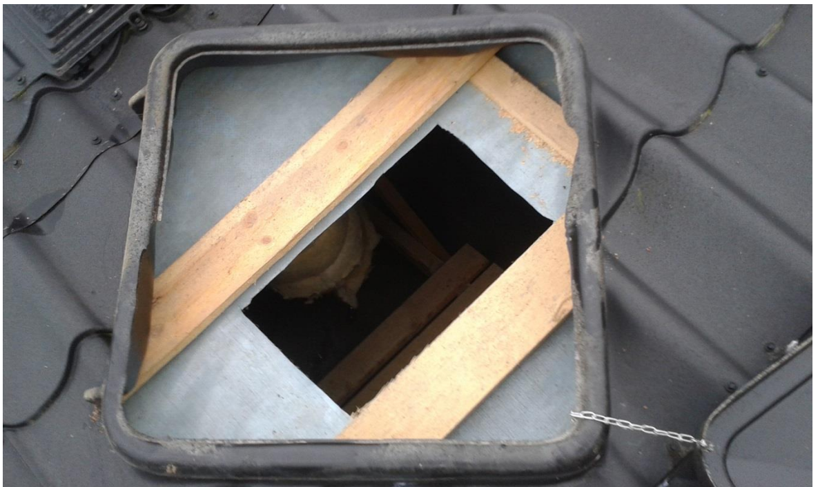
Kuva 27. Paloluukut ovat RakMK:n vastaisesti rakennettu.
