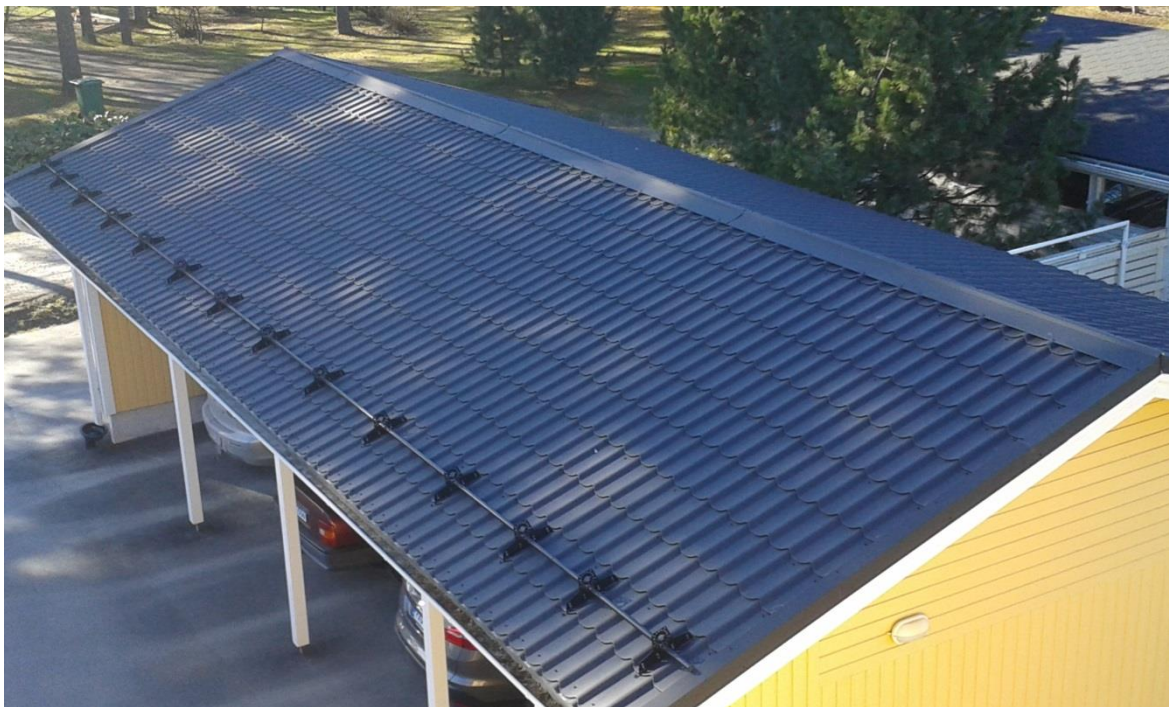
Kuva 22. Autokatos, lumiasteiden yläorret puuttuvat.
