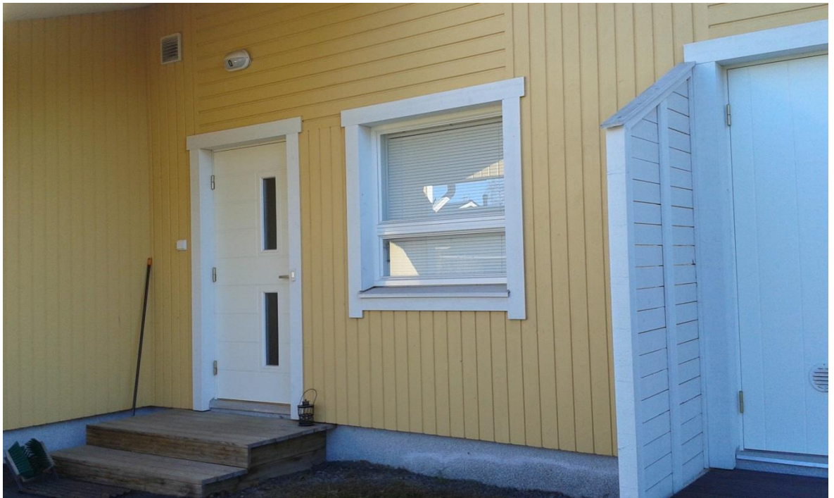
Kuva 18. D-huoneiston sokkelin tummentuma
