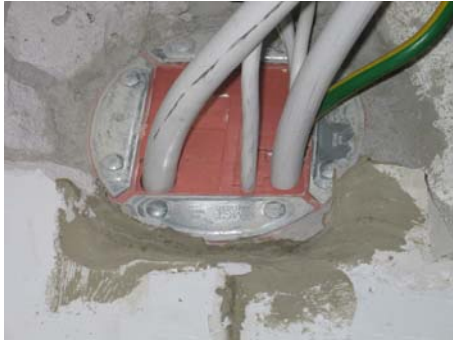
Kuva 4.3 Keskuskonttorin pääkeskushuoneen läpivienti.
