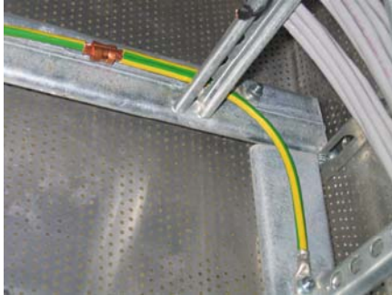
Kuva 4.1 Pääporttirakennuksen pääkeskushuoneen kaapelihyllyn maadoitus
