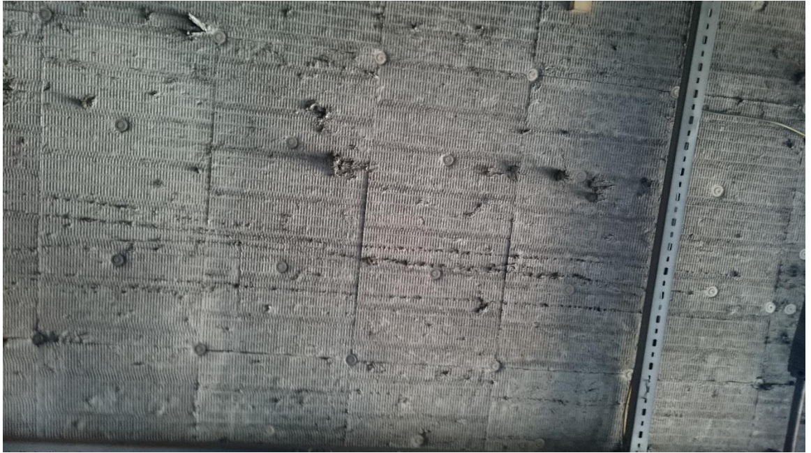
Kuva 33. Nykyisen maalaamohallin sisäkatto on päällystetty kuvassa näkyvällä äänieristyspaneelilla.
