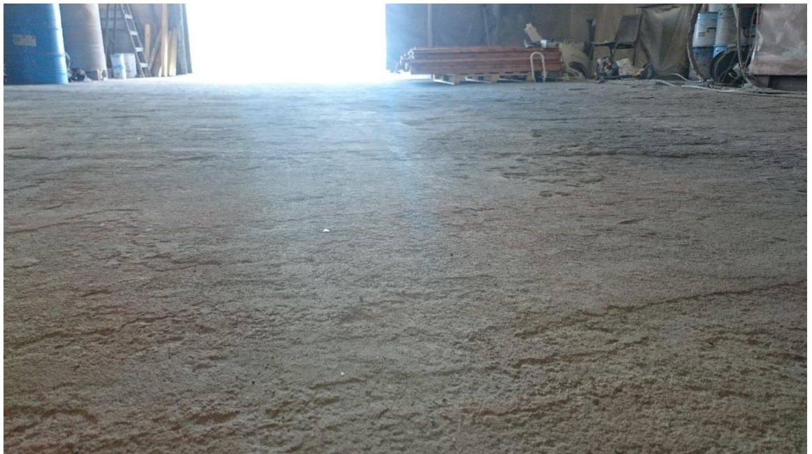
Kuva 12. Kuvassa nähtävissä nykyinen lattiapinta ja sen epätasaisuudet, jotka aiheuttavat lattian pölisemistä ja estävät puhdistukseen käytettävien vesien pääsyn lattiakaivoon.
