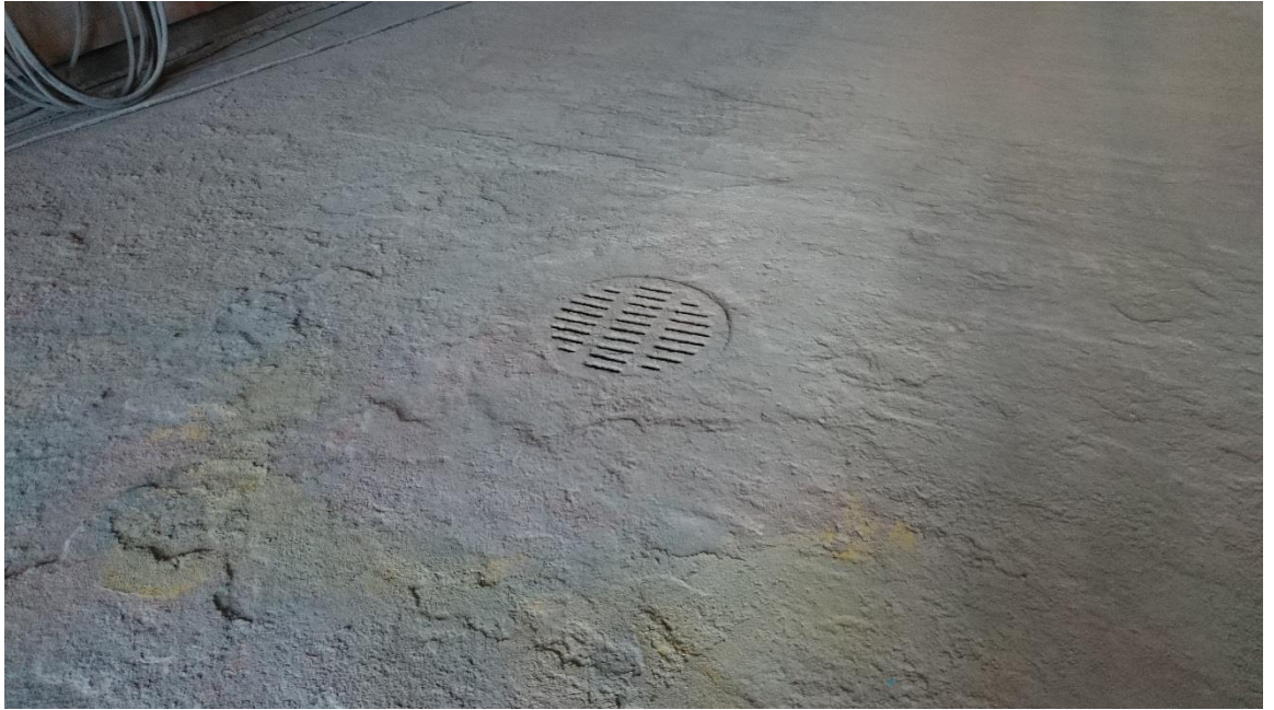
Kuva 13. Kuvassa hallissa oleva lattiakaivo, joka lattian epätasaisuuksien vuoksi ei kerää poistettavia likavesiä.
