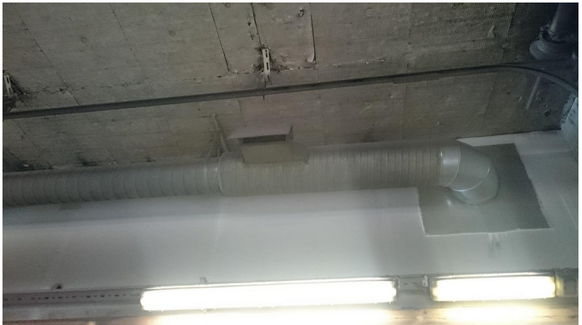
Kuva 17. Kuvassa maalaamohalliin tulevan tuloilmaputken venttiili, joita on tasaisin välein koko maalaamohallin seinustalla.
