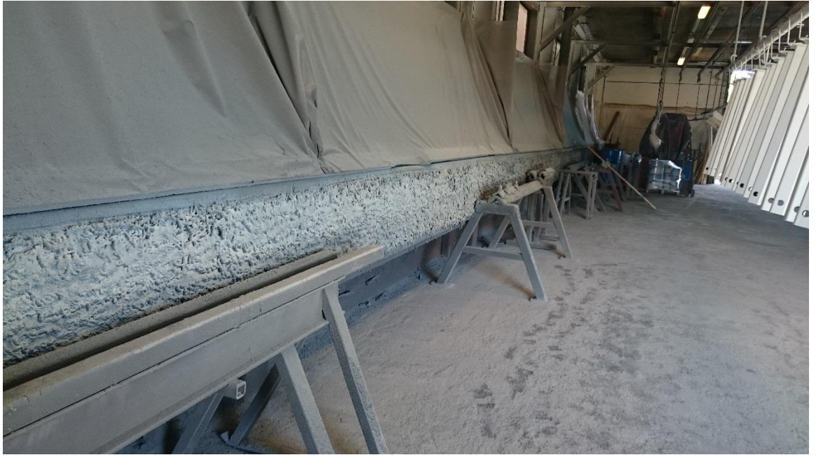
Kuva 18. Kuvassa näkyvä suodatinpalkki on maalaamotilan poistoilmajärjestelmä. Poistoilmajärjestelmä sijaitsee vastakkaisella seinustalla tuloilmaan nähden.
