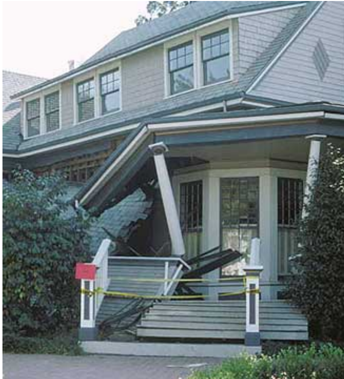
Kuva 2 Maanjäristyksen tuhoista selviytynyt puurakenteinen omakotitalo San Franciscossa vuonna 1989 /9/.
