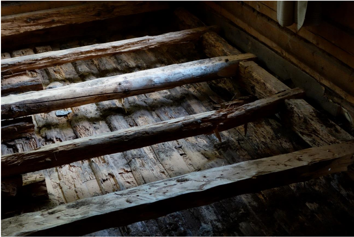
KUVA 11. Alapohjan kastuneen eristekerroksen aiheuttamia vaurioita
