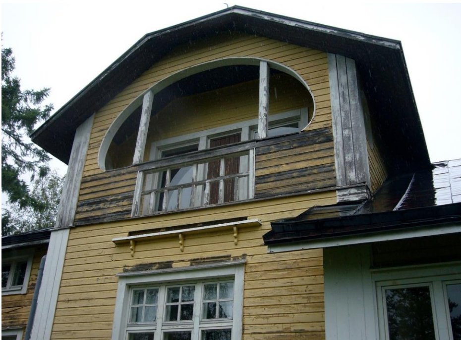
KUVA 15. Julkisivun vaurioita parvekkeen kaiteessa
