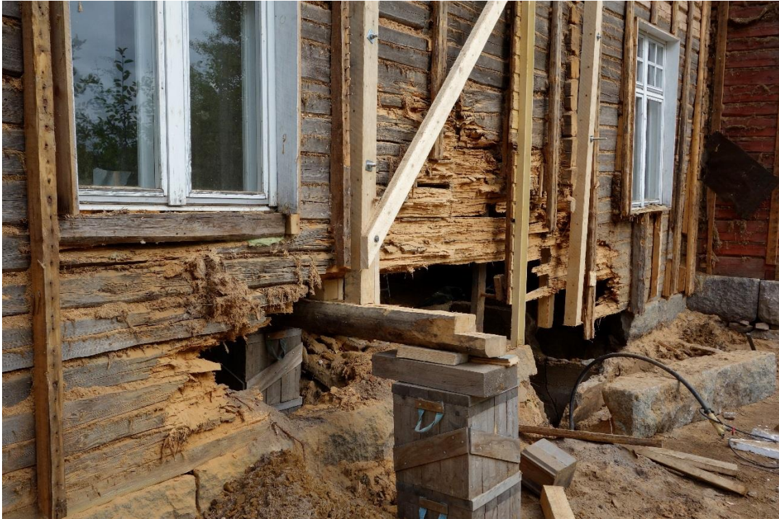
KUVA 13. Hirsiseinän haastava lahovaurio Koivulassa
