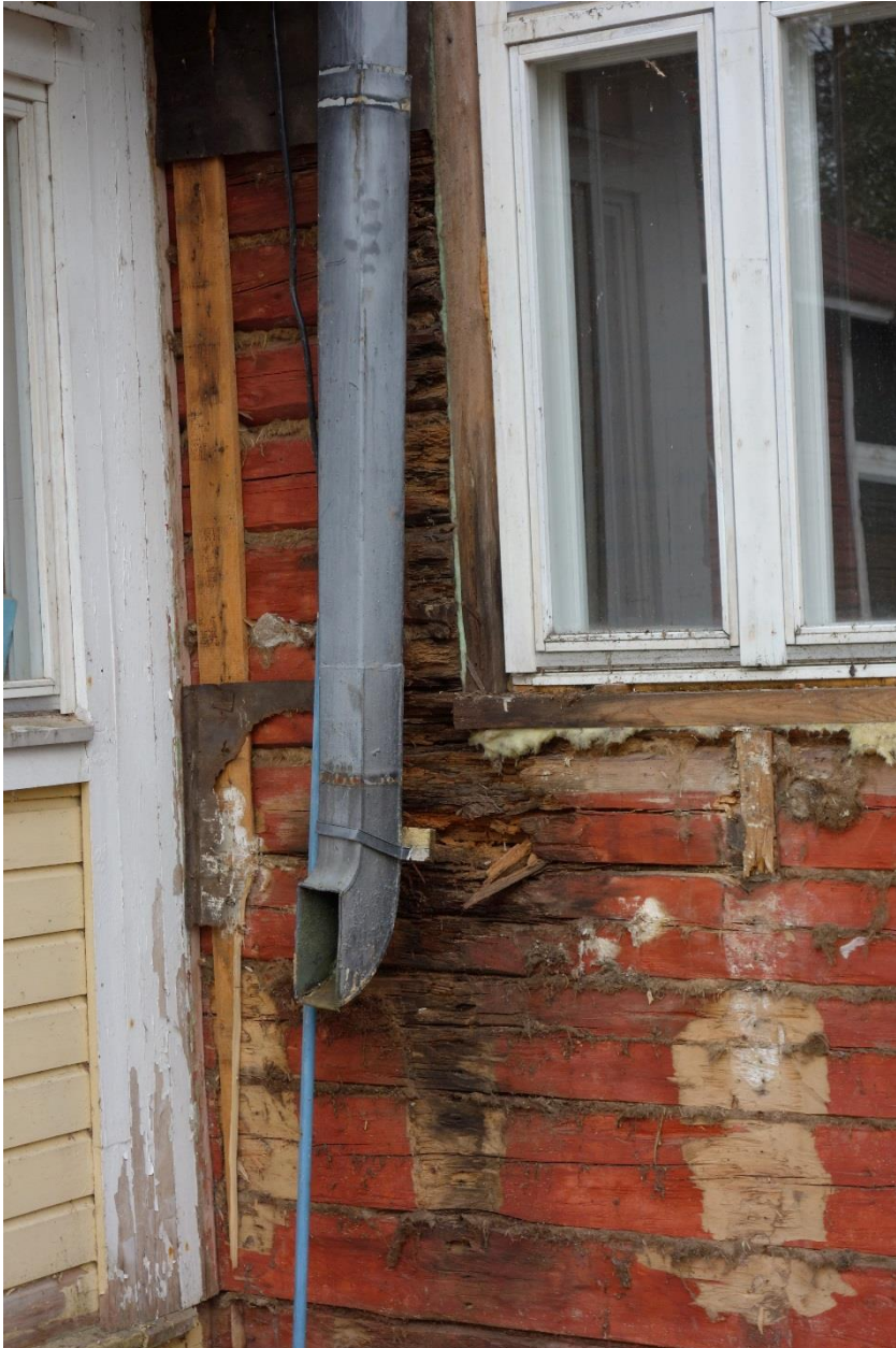
KUVA 14. Koivulan runkoon lahovaurioita aiheuttanut vuotava ränni
