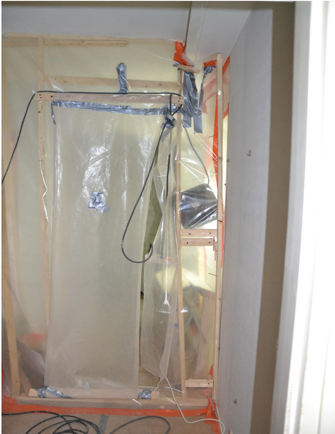
Kuva 18. Ilmastointiteipillä paikattu osastoiva seinä.
