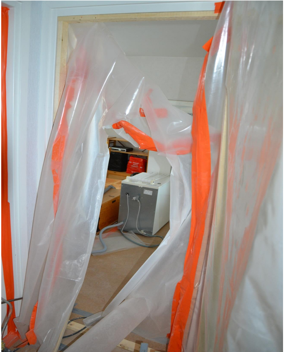
Kuva 19. Suojaseinä voi revetä pahoin siitä työvarusteiden kanssa läpi käveltäessä.
