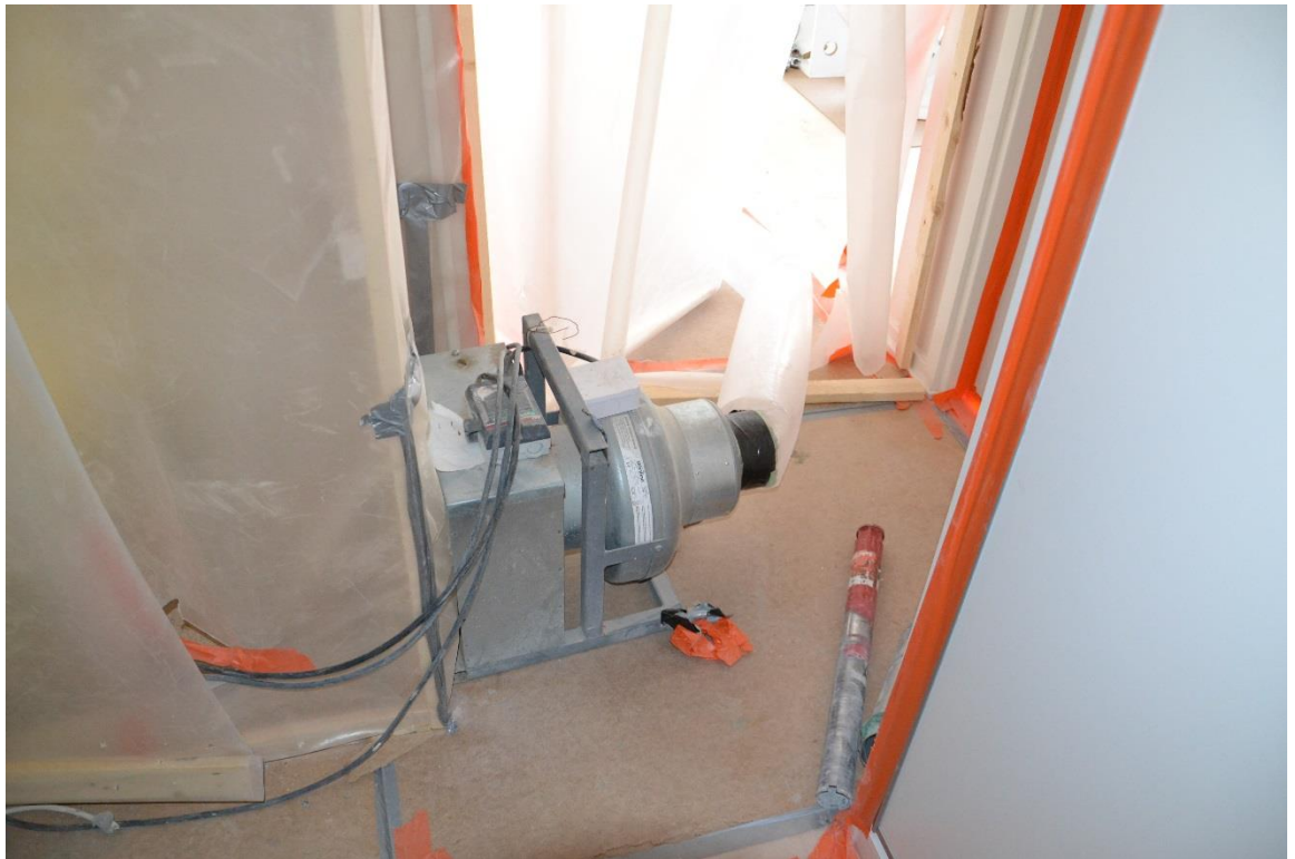
Kuva 11. Osastoidun tilan ulkopuolelle asetettu alipaineistaja.
