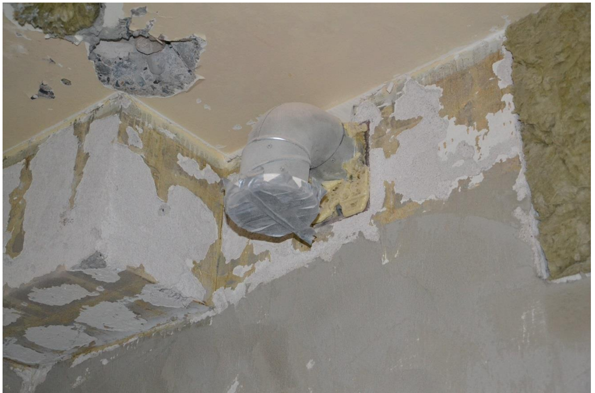
Kuva 25. Teippauksilla ja muovilla tukittu ilmanvaihdon sisääntuloventtiili.
