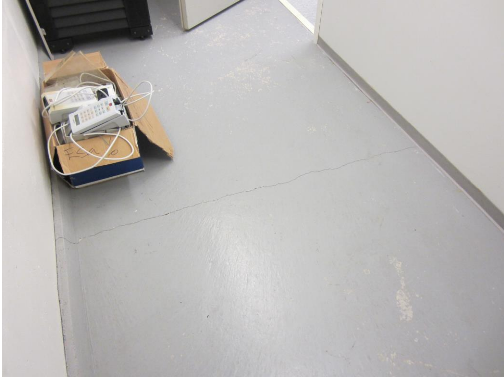
Kuva 5: Halkeama kellarikerroksen lattiassa
