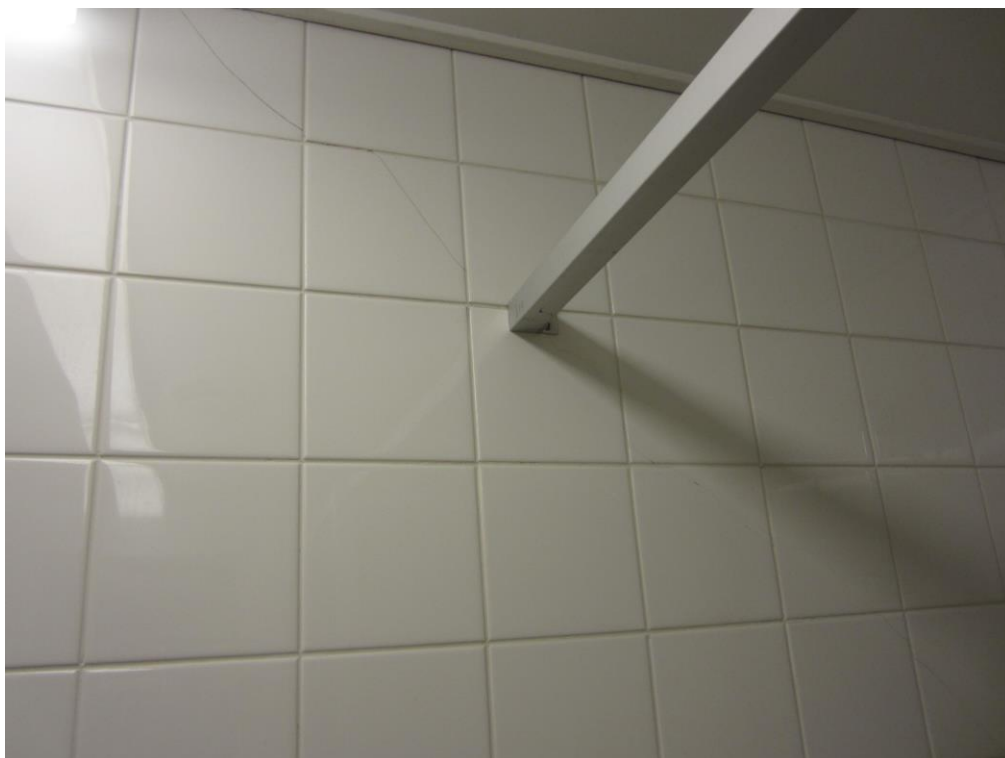
Kuva 13: Haljenneita laattoja alakerran pesuhuoneessa
