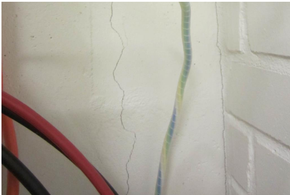
Kuva 11: Halkeama betonirakenteisessa väliseinässä
