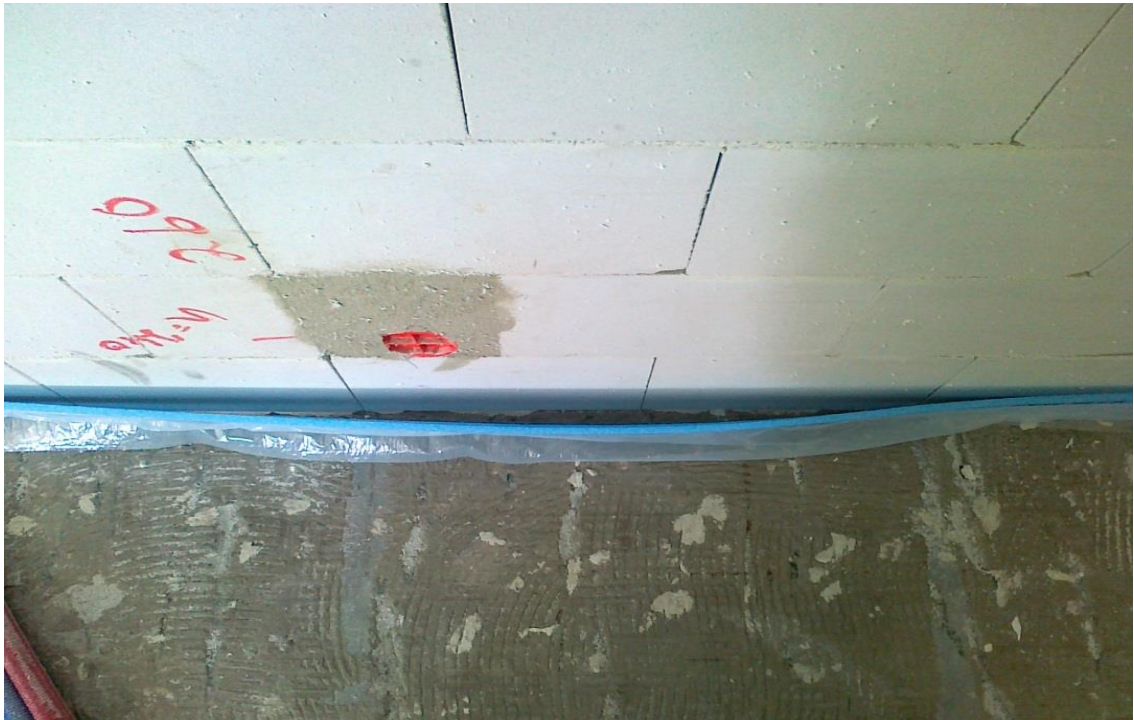
KUVA 19. Reunanauhan liima ei tarttunut kunnolla kivirakenteisiin seiniin, kiinnitys- alustan esipuhdistuksesta huolimatta.
