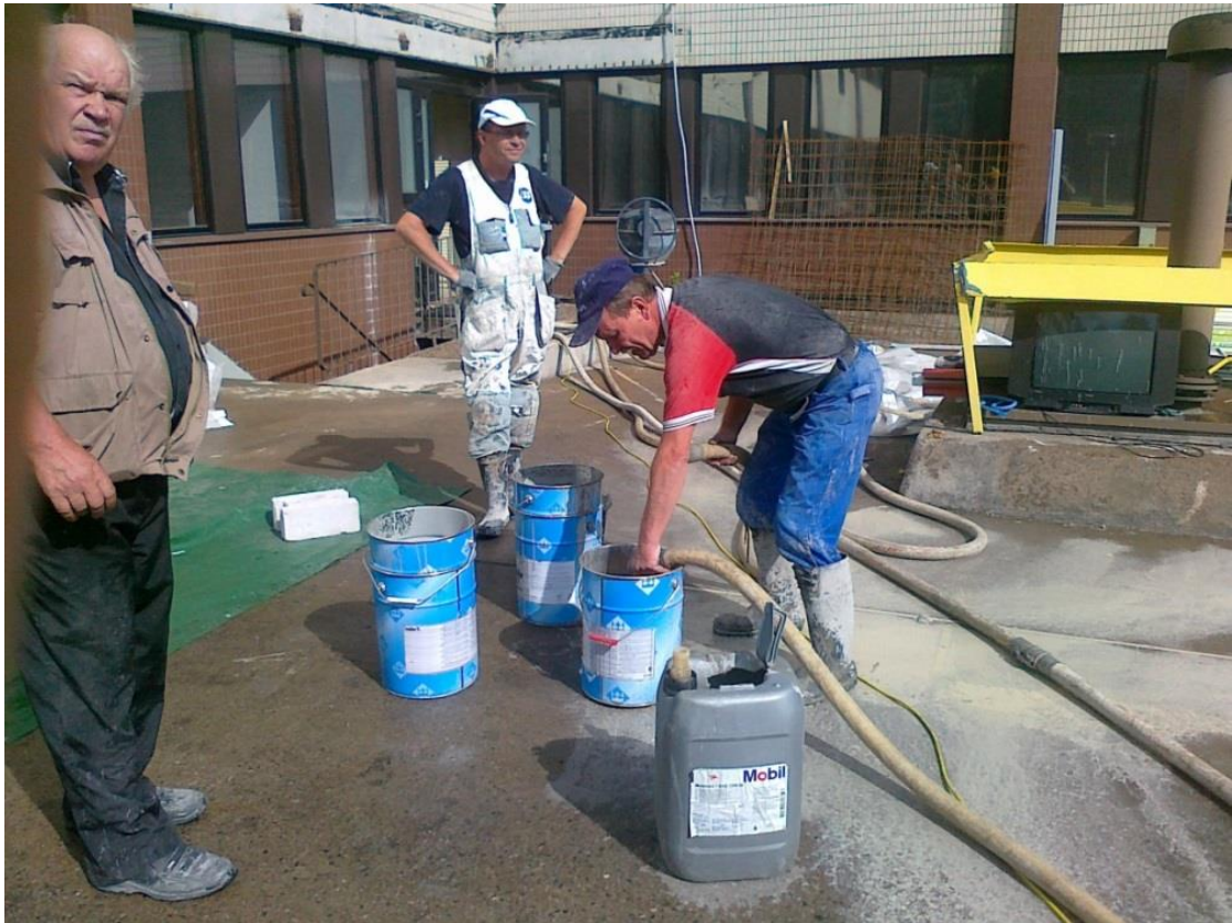
KUVA 12. Helteiden ansiosta tasoitemassa juuttui letkuihin.
