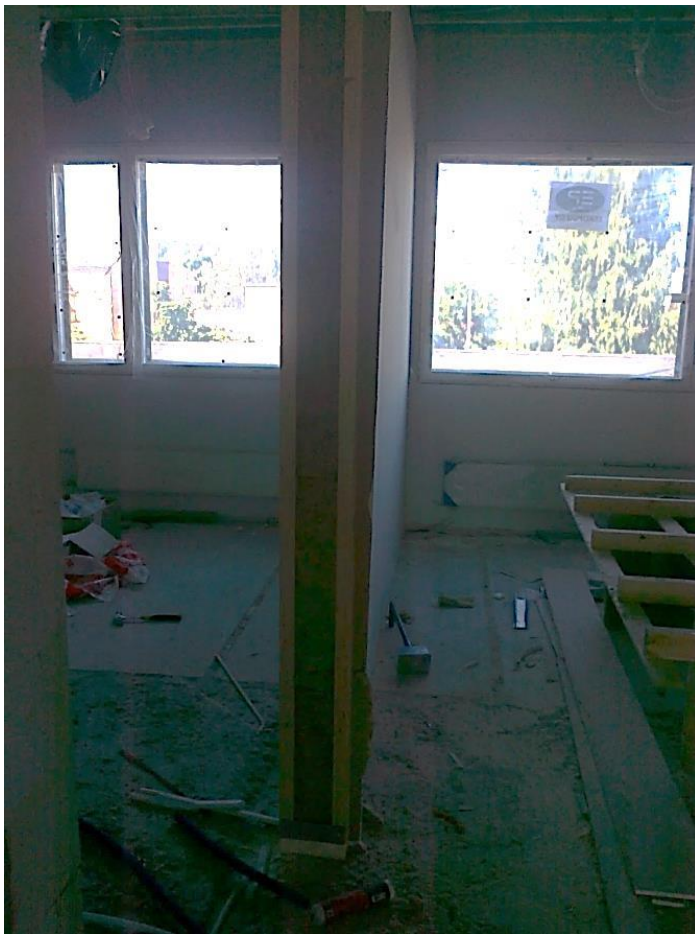
KUVA 8. Vanha läpivienti, joka on valettu umpeen
