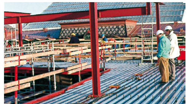
Kuva 6.14 Liittovälipohja, jossa on käytetty erikoismuotoilua profiloitua levyä, on asetettu teräspalkin päälle. Teräspalkki, levy ja betoni vaikuttavat yhdessä ja parantavat kantokykyä.
