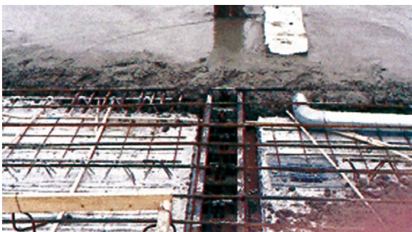
Kuva 6.13 Kuorilaattavälipohja on esivalmistettu betonielementti, joka asetetaan teräspalkin alalaipalle. Installaatiot voidaan sitten vetää betonielementin päälle ja valaa kiinni, kun päälle valetaan betonia.
