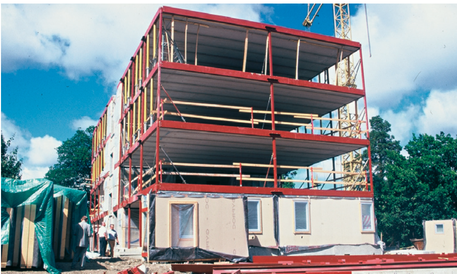
Kuva 6.28 Kuvan asuinrakennuksessa käytetään ontelolevyvälipohjaa, joka jännittää julkisivun julkisivuun. Näin syntyy avoin, joustava tila, johon voidaan rakentaa huoneistoja.
