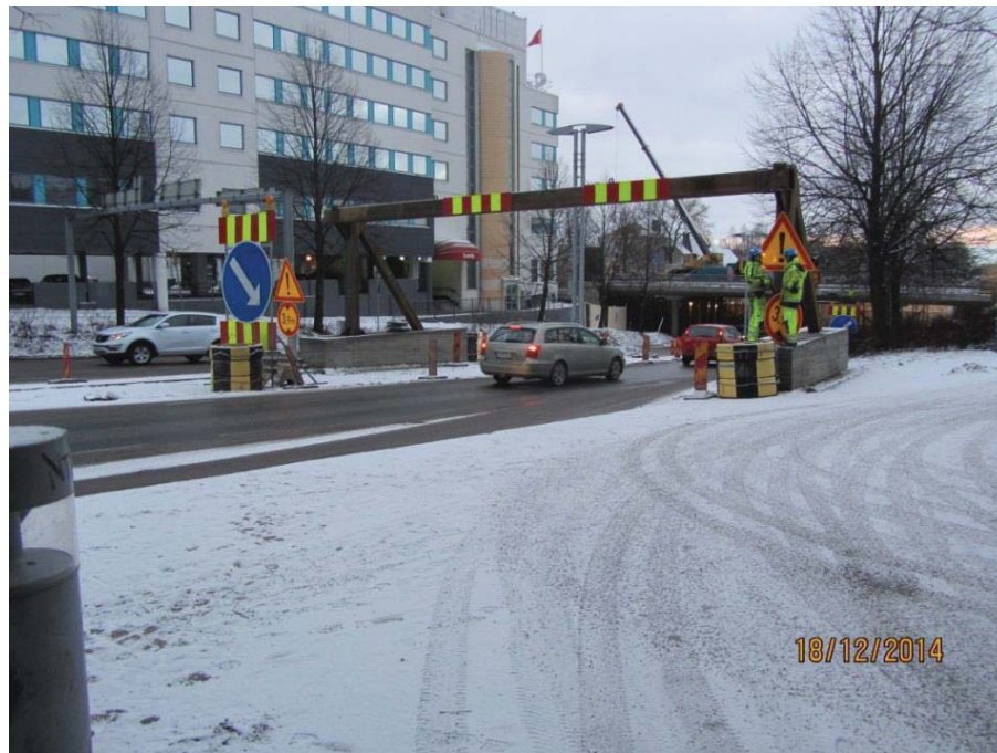
Kuva 13. Vesijärvenkadulle järeistä metallipalkeista rakennettu korkeusrajoitin, joka estää ylikorkeiden autojen pääsyn työalueelle ja takaa turvallisen työskentelyn sillan kannen telineellä.
