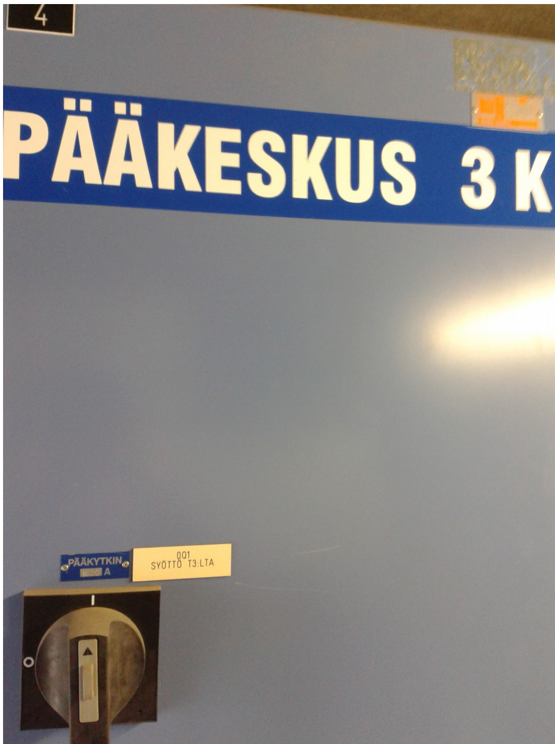
Kuva 10: 3K nousukeskuksen pääkytkin.
