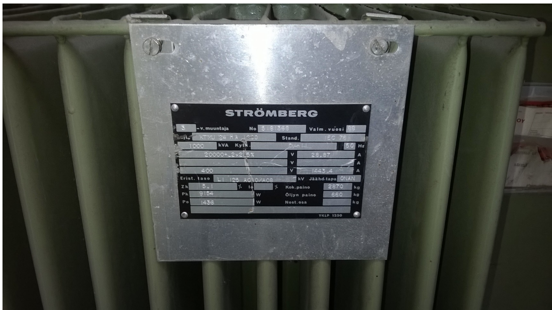
Kuva 4: Muuntajan T3 arvokilpi.
