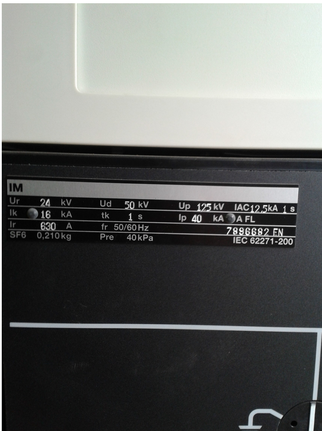
Kuva 5: Muuntajan T3 kytkinlaitteiston arvokilpi.
