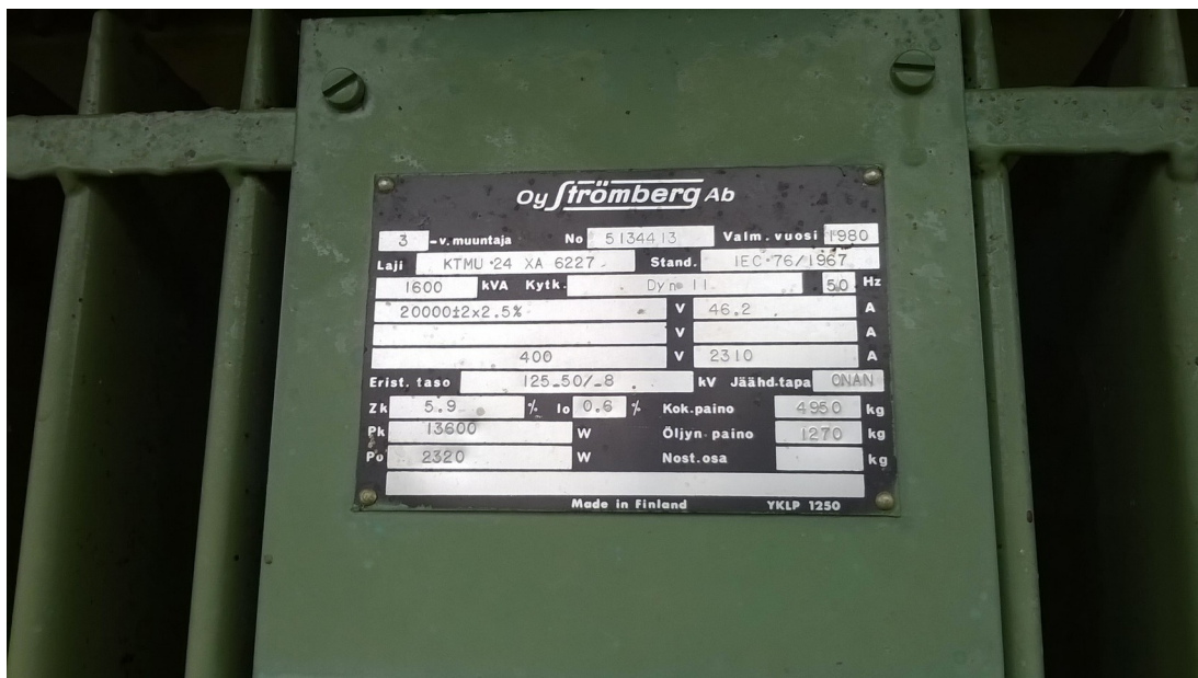
Kuva 6: Muuntajan T4 arvokilpi.
