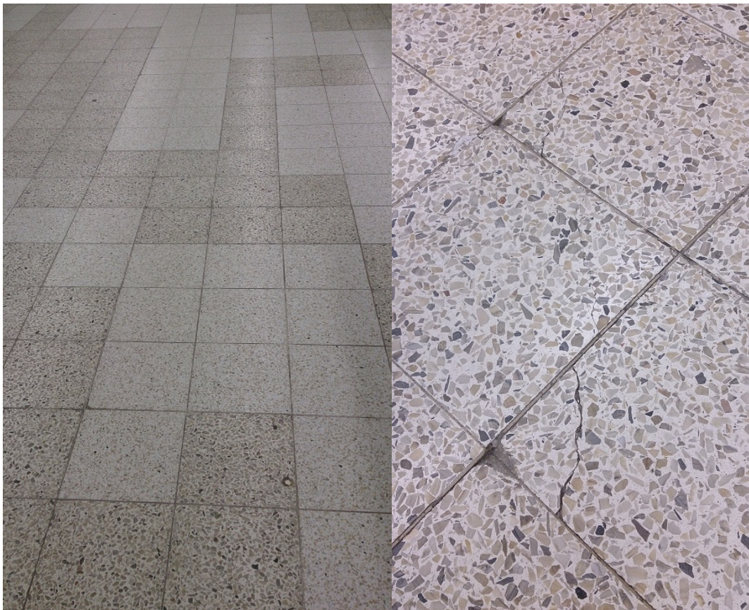
KUVA 2. Vaihdettuja laattoja ja halki olevia laattoja (Kuva: Niittynen 2015)
