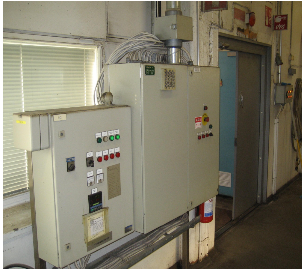
Kuva 23. Vas. kaasujärjestelmän ja oik. vohveliuunin sähkökaappi
