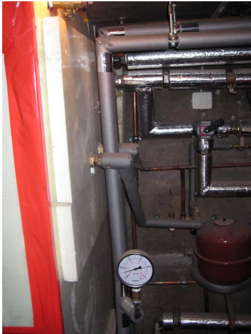
Kuva 17 Lämmönvaihdin keräimiltä lämminvesivaraajaan
