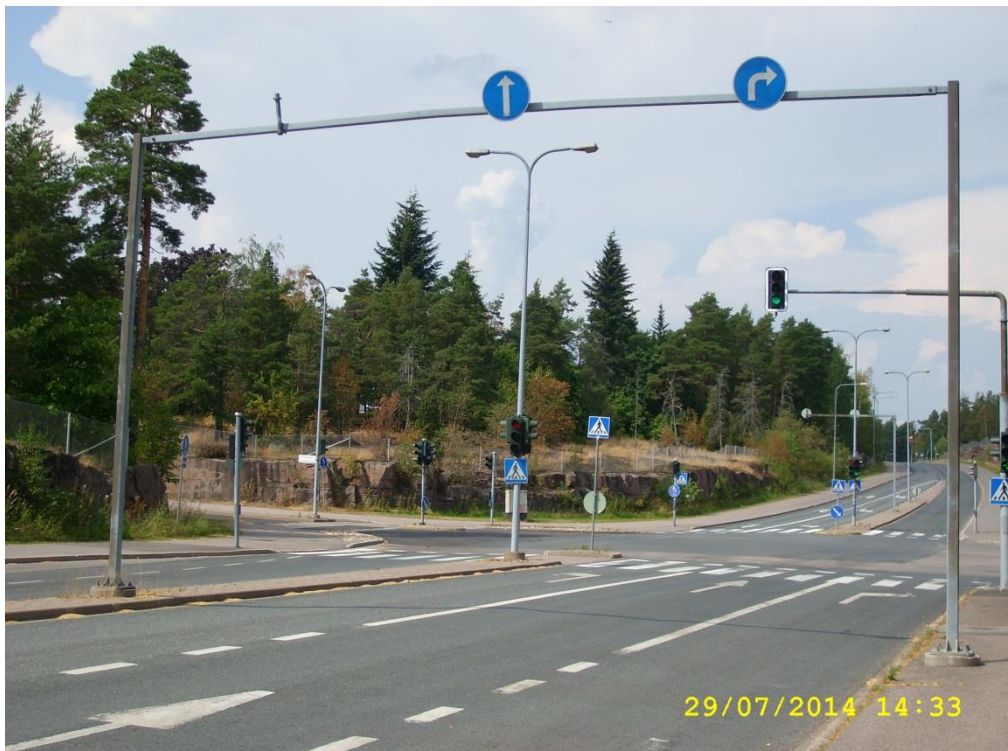
Kuva 12. Kuvassa portaali, josta on kadonnut yksi liikennemerkki. Nuoli vasemmalle kadonnut. (Uuskartanontie, Espoo)
