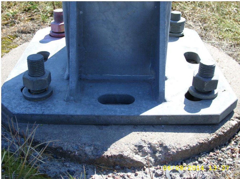
Kuva 10. Kuvassa kehäportaali, minkä toisessa jalassa mutterit silmiin nähden löysällä. Ilmeisesti unohtunut kiristää asennuksen tai tilapäisen portaalin poiston yhteydessä. (Koivu-Mankkaantie, Espoo)
