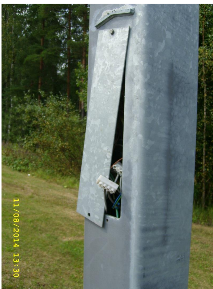
Kuva 14. Huoltoluukku auki. Johdot avoimesti esillä. Sähköasennus jäänyt kesken? Ylismäentie, Espoo)
