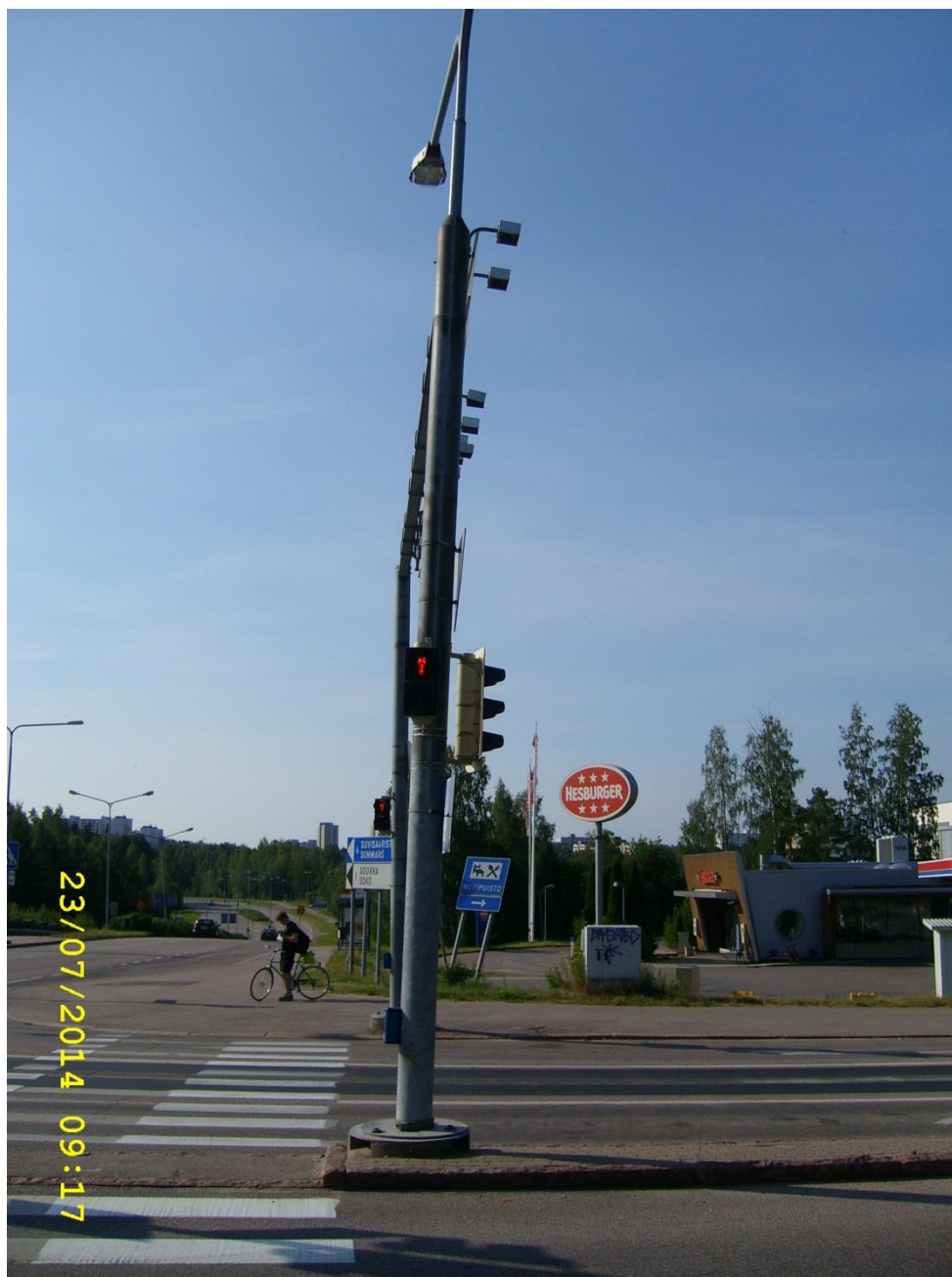
Kuva 23. Kuntoluokka 2 Välttävä. Reilua kallistumista, tai muuta seurantaa vaativaa ongelmaa havaittavissa. (Kivenlahdentie, Espoo)
