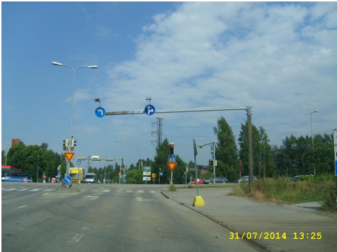
Kuva 24. Kuntoluokka 1 huono. Isompia ongelmia havaittavissa. Esimerkiksi kuvan portaaliin törmätty, minkä seurauksena portaali mutkalla ja nurjahdusvaara jo todellinen (Niittykatu, Espoo).
