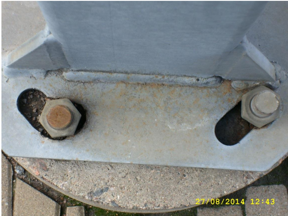
Kuva 11. Kuvassa mutterien aluslevyt puuttuvat. Mutterit kantavat vain pieneltä alalta. Vasemman puoleinen mutteri kantaa vain kahdelta nurkkakantilta. (Hevosenkä, Espoo)
