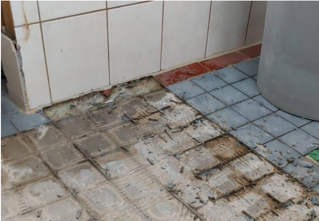
KUVA 18. Suihkun roiskevedet päässeet laatoituksen läpi rakenteisiin ja kasteleet lattiabetonia.
