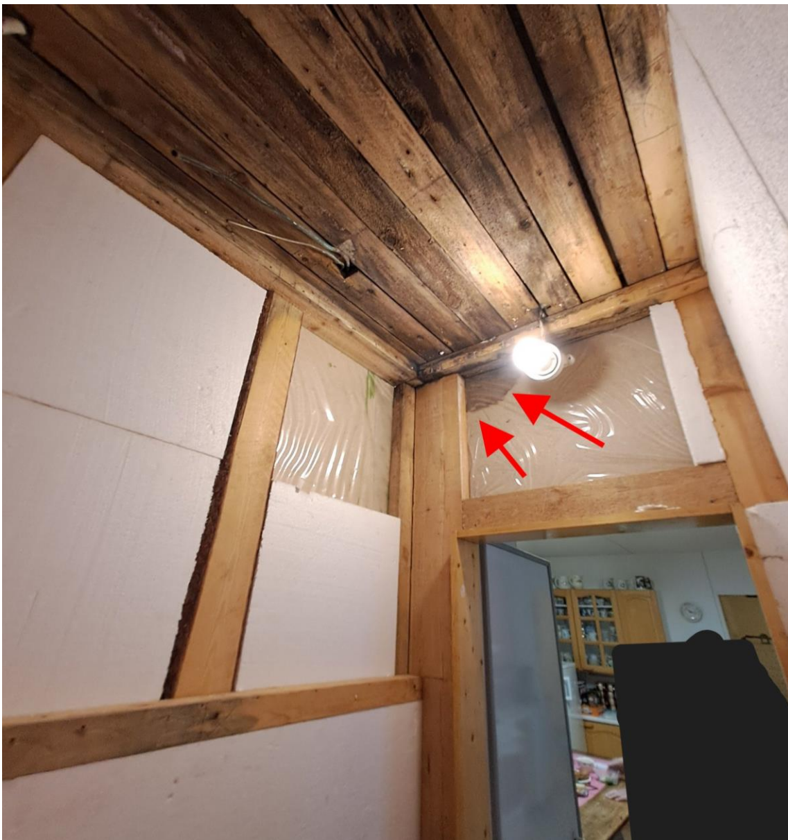
KUVA 23 Kylmiön pinnat purettu, jolloin runkorakenteista löydettiin vaurioita.
