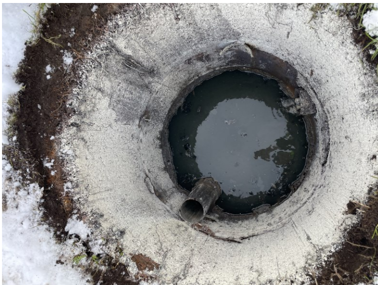
KUVA 3. Toinen nykyisistä saostuskaivoista, josta voidaan todeta kaivojen huonokuntoisuus (Hyytiäinen, 2/2024)
