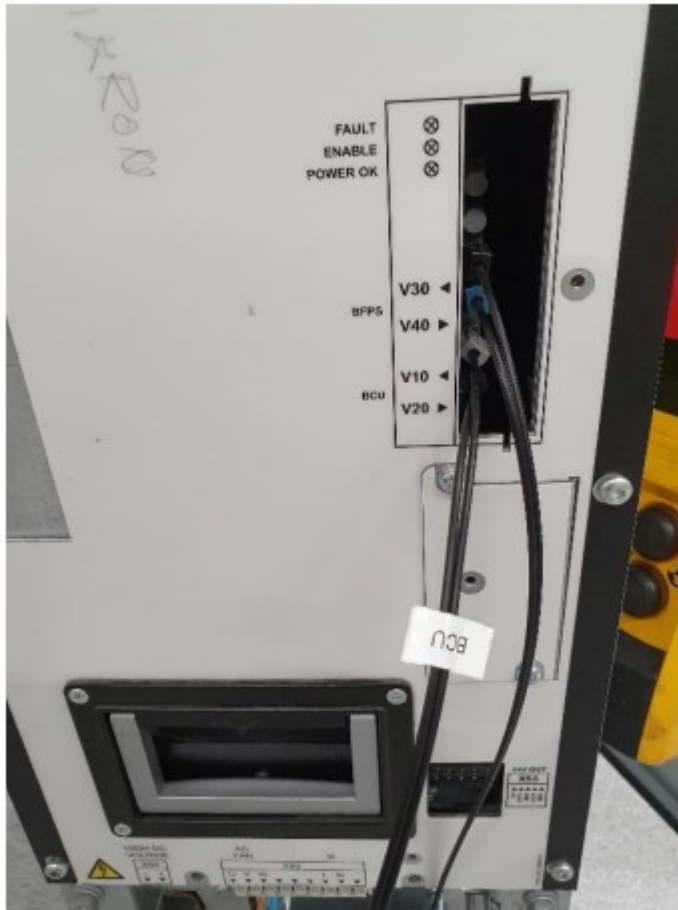
Kuva 10. Optisten kaapeliin kytkentä (BCU)
