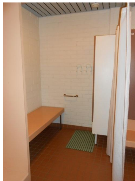
Kuva 12: Esteetön WC tilat ovat ahtaat, eikä kalusteisiin välttämättä yllä
