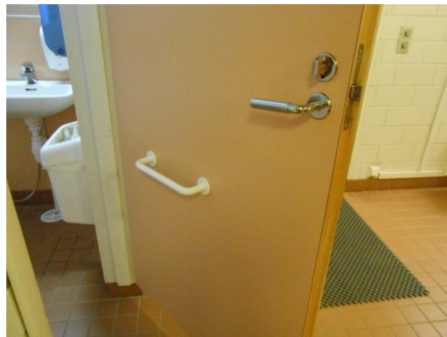
Kuva 13: Esteettömän WC- ovi on kapea, ja siitä puuttuu lankavedin
