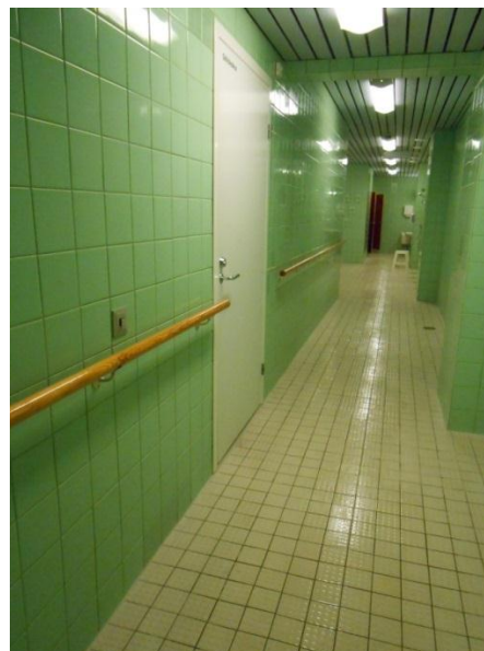
Kuva 20: Allasosastolle johtavan käytävän käsijohde on ainoastaan yhdessä tasossa ja katkeaa oven kohdalla.
