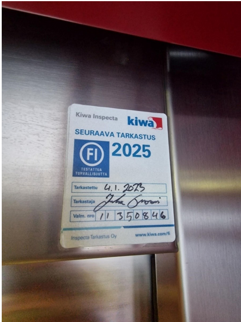
Kuva 4. Määräaikaistarkastuksen tarra hississä.
