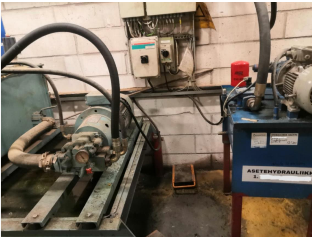
KUVA 3. Hydraulikkalaitteiden merkintöjen tarkastelua (Itse otettu projektikuva)
