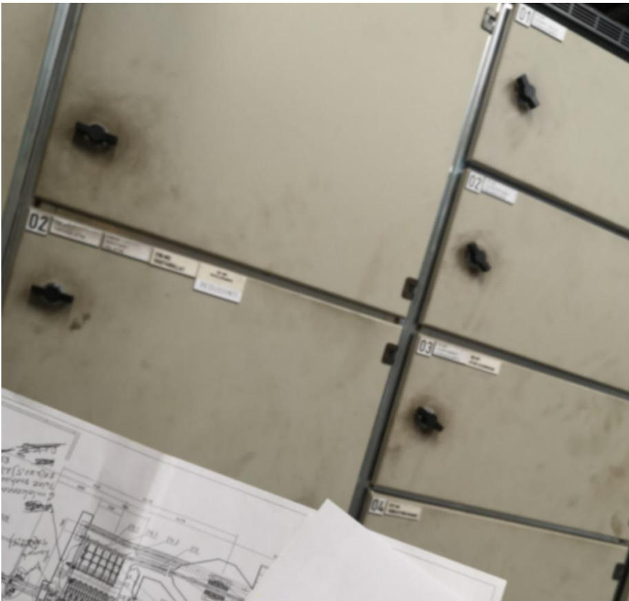
KUVA 2. Kaavio ja sähkökeskus (Itse otettu projektikuva)
