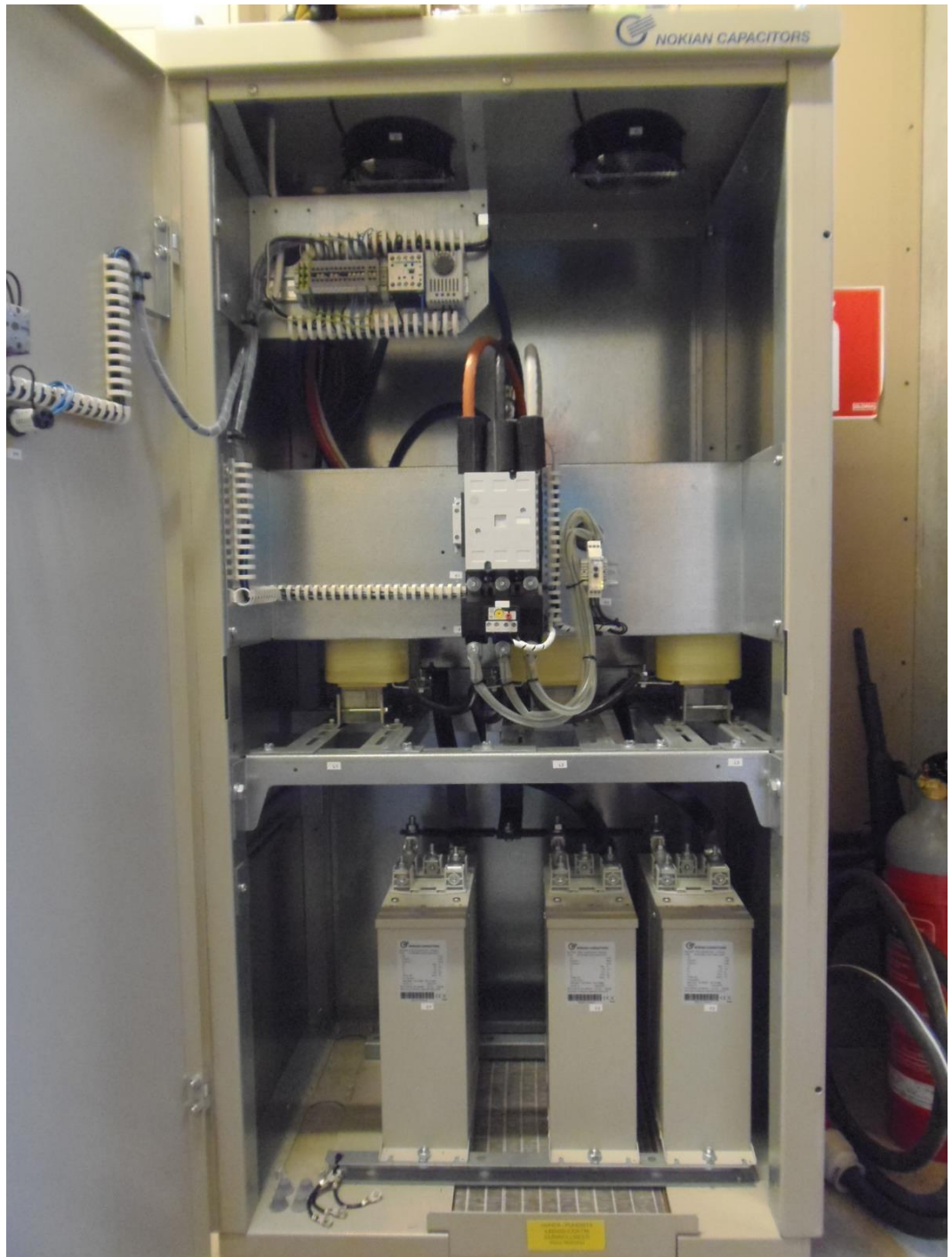
KUVIO 47. Automaattinen loisteho/estokela yksikkö (Sähkörenki Ky).
