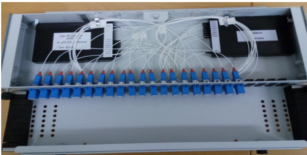
Kuva 9. Mux- ja Demux-passiivilaitteet kuidutettuna.
