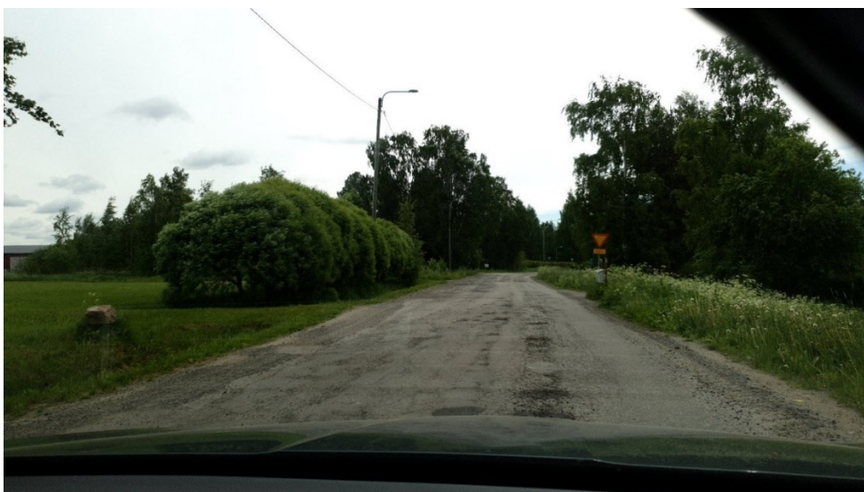
Kuva 7. Tierakenteen huonokuntoisuus vaikutti merkittävästi tien käytettävyyteen.
