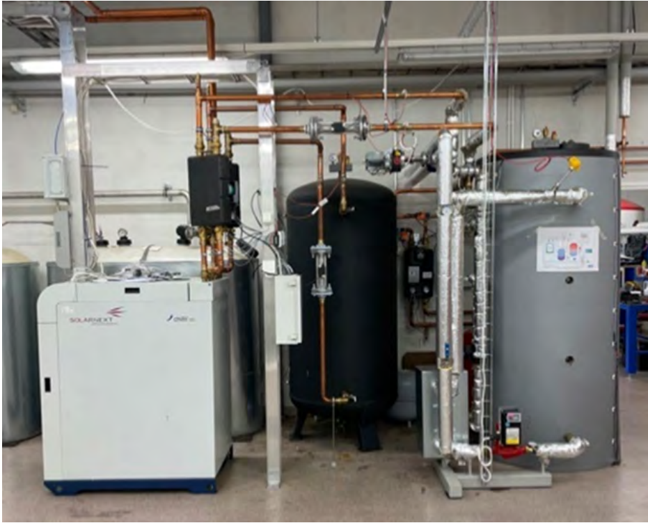
Kuva 19. Adsorptiojäähdytyn yksikkö BioSampo-tutkimuskeskuksessa on kuvassa vasemmalla. Harmaa säiliö, kuvassa oikealla, on laitteiston kuumavesisäiliö, musta kylmavesisäiliö on keskellä ja lämmönsiirtimen sijainti on kuumavesisäiliön vieressä alhaalla. (Kuva: Maunu Kuosa)
