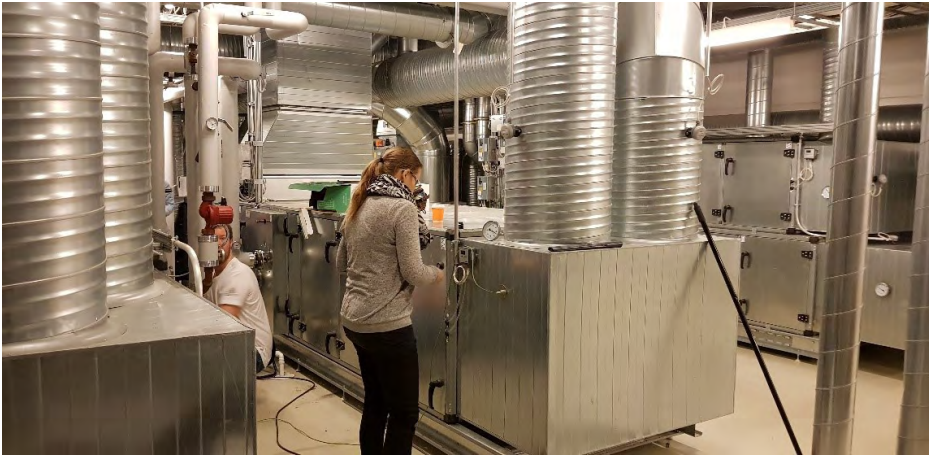
Kuva 14. Poistoilmakone PK3 ja mittaukset lämmöntalteenottopotentialin määrittämiseksi. (Kuva: Tuija Korpela)
