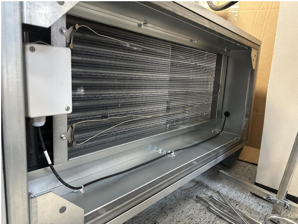
KUVA 14. Lämmityspatteri ja jäätymissuoja-anturi. (Kuva: Arttu Kaunistoinen 2023)
