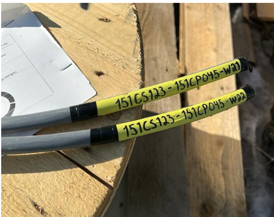
KUVA 11. Kaapelinpäiden suojaus ja merkintä.
