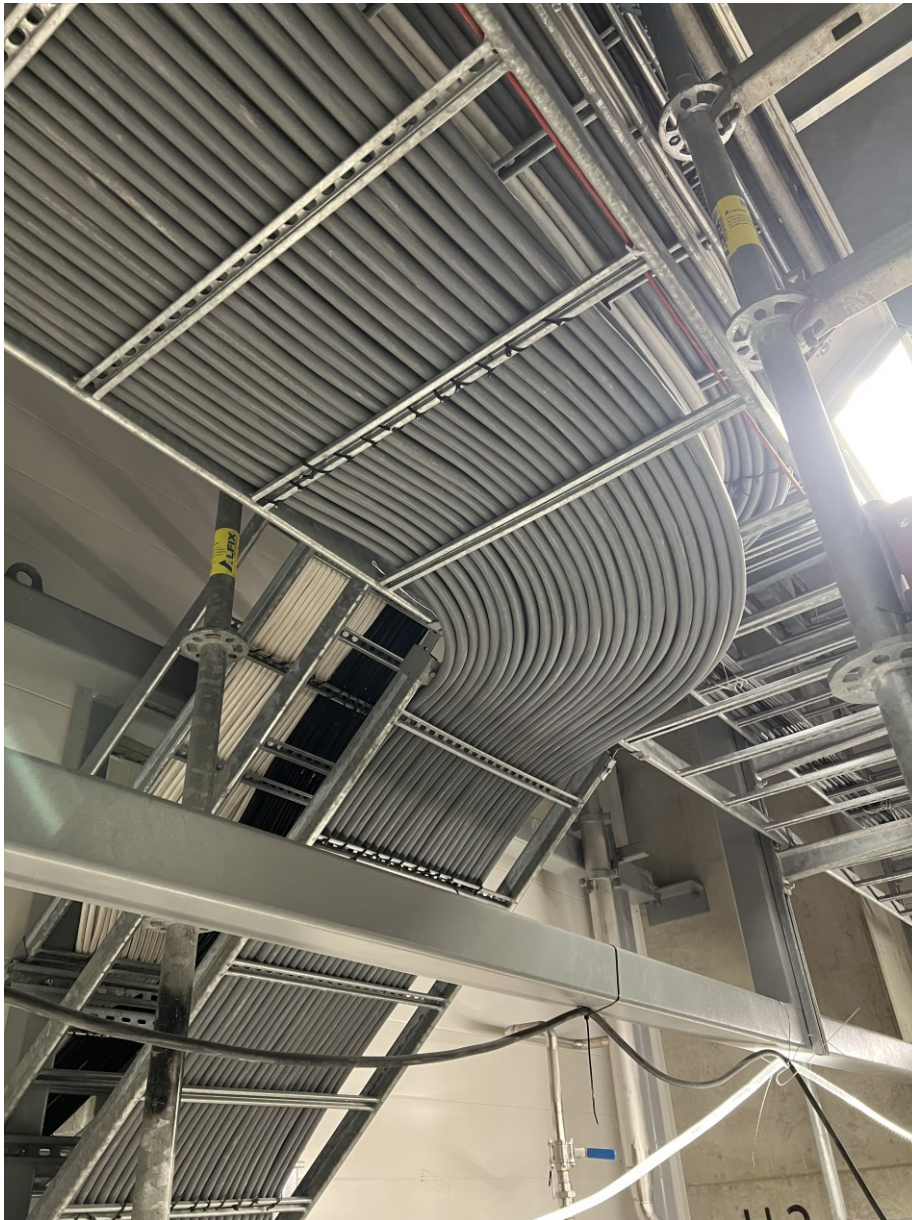
KUVA 12. Oikeaoppisesti toteutettu kaapelointi.
