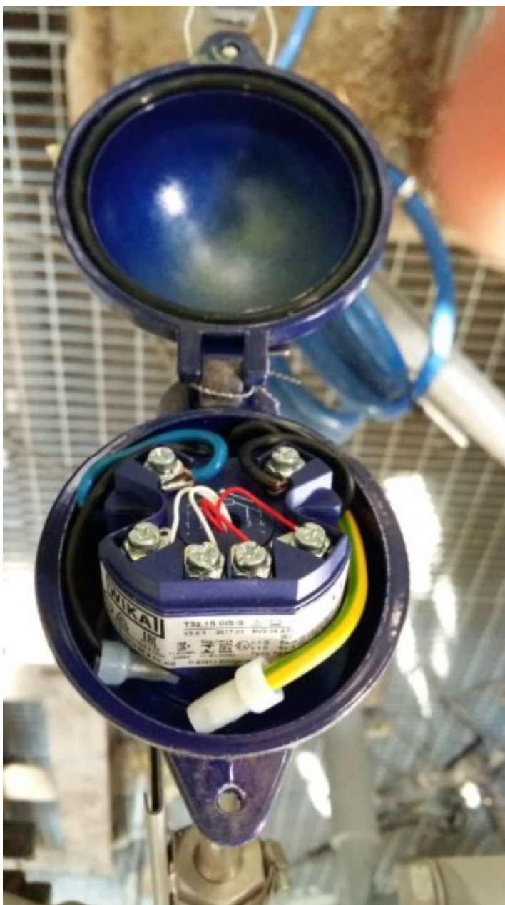
KUVA 17. Exi-piirin oikeaoppinen kytkentä MACM kaapelilla.
