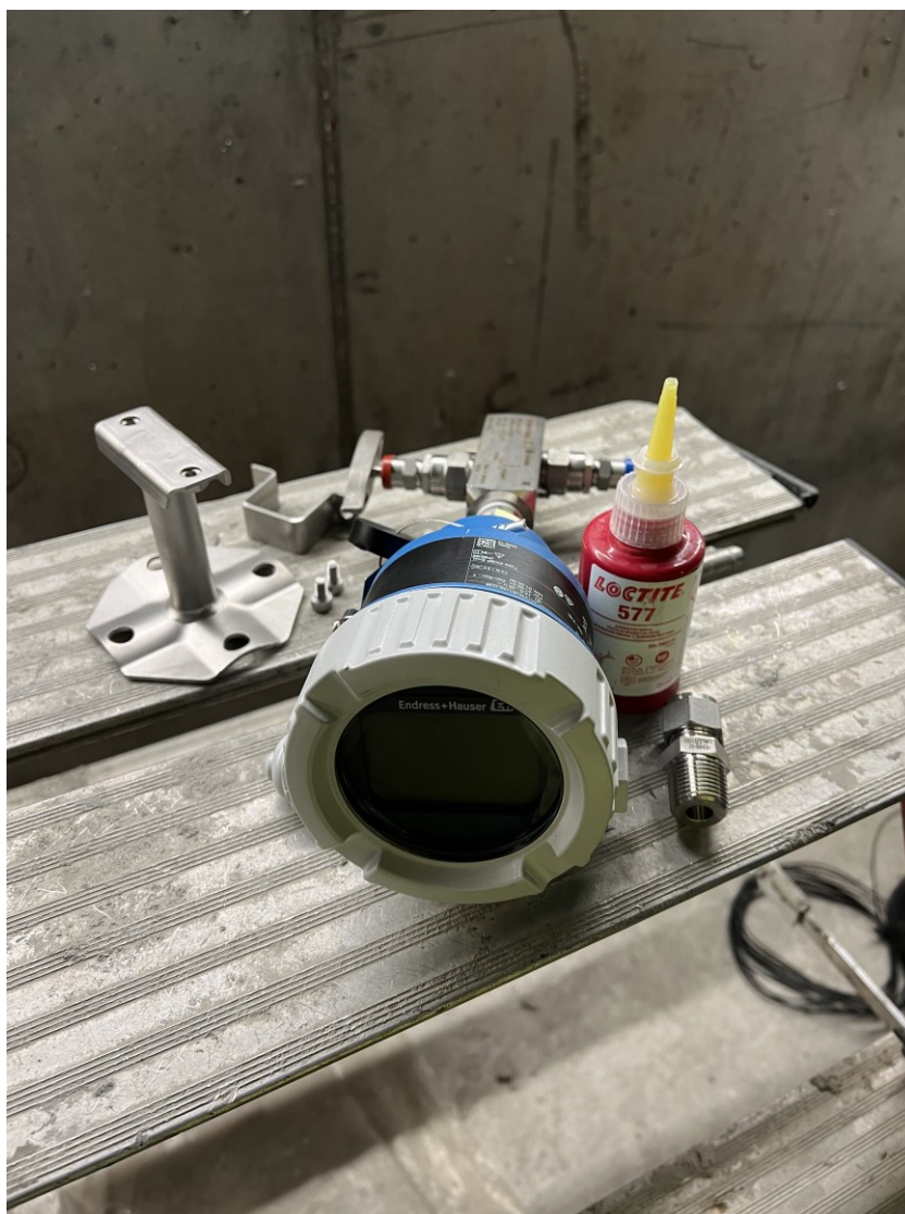
KUVA 5. Impulssiputkitettava lähetin 2-tie venttiilillä painemittaukselle.
