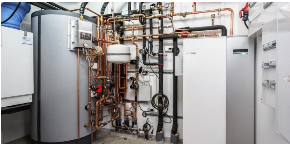
Kuva 10. Maalämpöpumppu ja lämminvesivaraaja [28]
