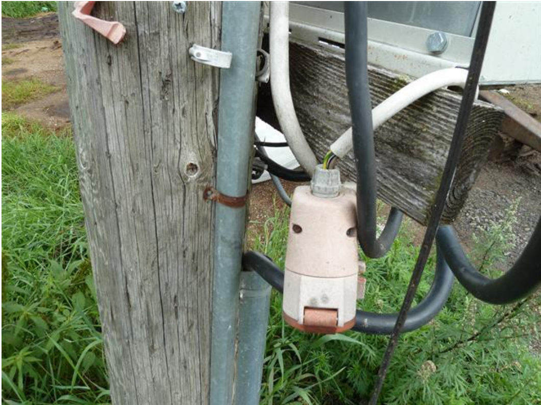
Kuva 3. Tiiveys ja vedonpoisto puutteellinen.
