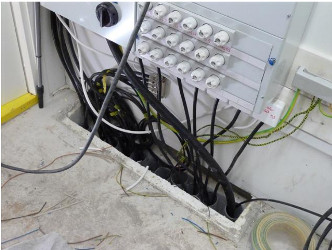
Kuva 5. Kaapelien mekaanin suojaus puutteellinen.
