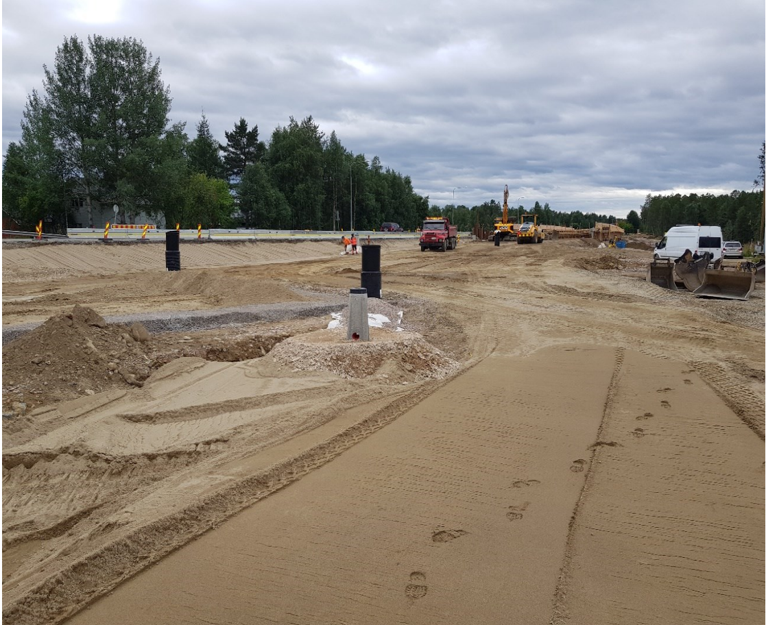
Kuvio 16. S1 vesistösillan ja S2-alikulkukäytävän välissä olevien kuivatusjärjestelmien ja varusteiden rakentamista (Heikkilä 2022b)
