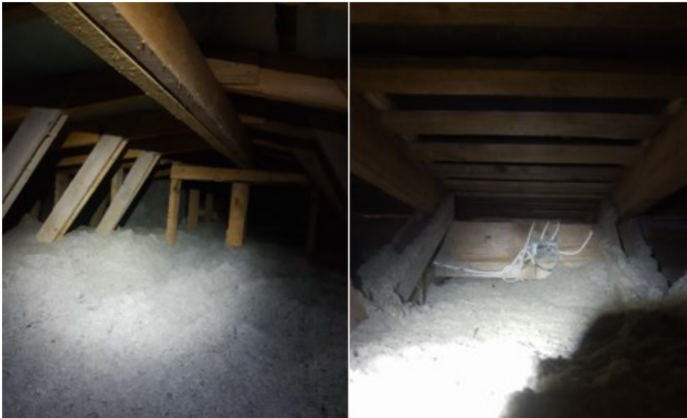
KUVA 7. Yleiskuva yläpohjasta sekä avoin sähkörasia
