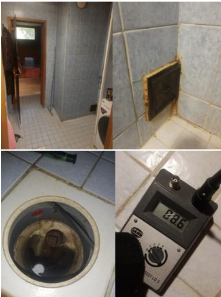
KUVA 9. Yleiskuva kylpyhuoneesta sekä havaitut epäkohdat
