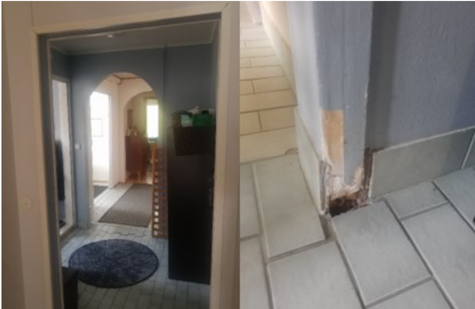
KUVA 16. Yleiskuva käytävästä sekä kosmeettisesta vauriosta
