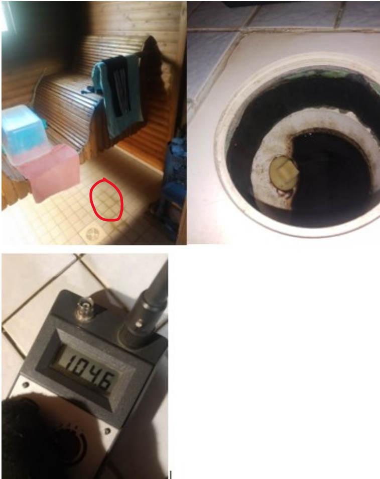
KUVA 10. Yleiskuva saunasta sekä havaitut epäkohdat
