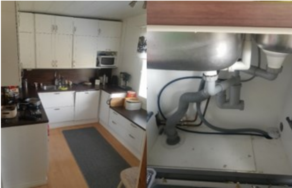
KUVA 12. Yleiskuva keittiöstä sekä astianpesukoneen putkistoista
