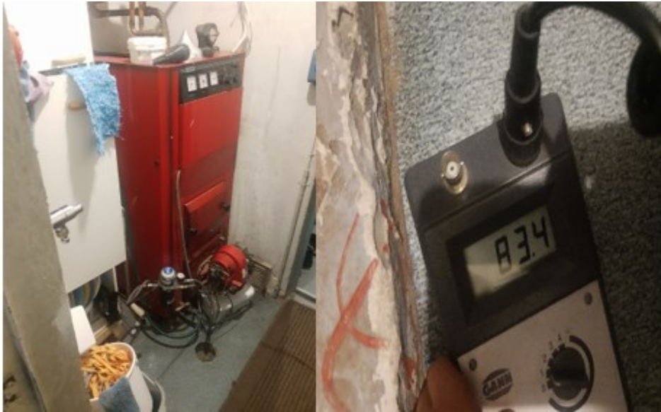
KUVA 17. Yleiskuva pannuhuoneesta sekä lattian kosteusmittauksesta
