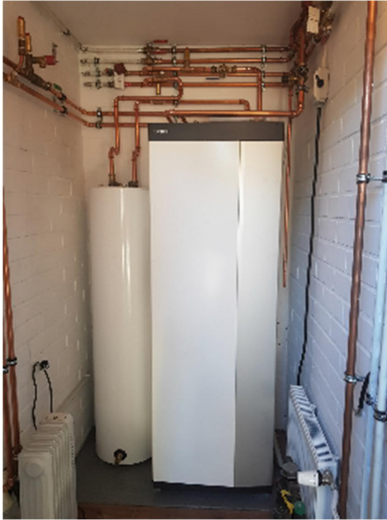
Kuva 23 Uusi lämmitysjärjestelmä asennettuna. (Kuva: Miro Salmelainen)
