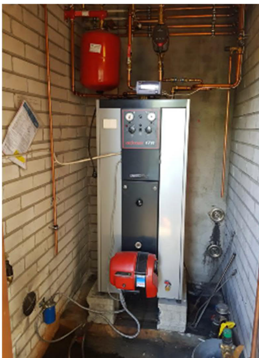
Kuva 19 Öljylämmitysjärjestelmä, ARIMAX 17R, Junior Pro1 LJ10 poltin, kierto- vesipumppu ja ohjainyksikkö. (Kuva Miro Salmelainen)
