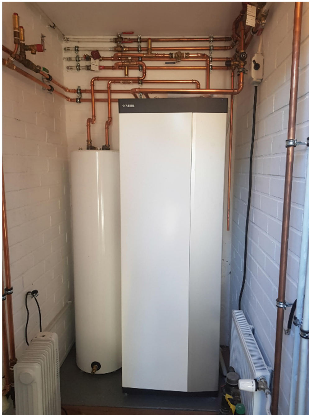
Kuva 10 Ilma-vesilämpöpumpun sisäyksikkö NIBE VVM S32 ja puskurivaraaja. (Kuva: Miro Salmelainen)
