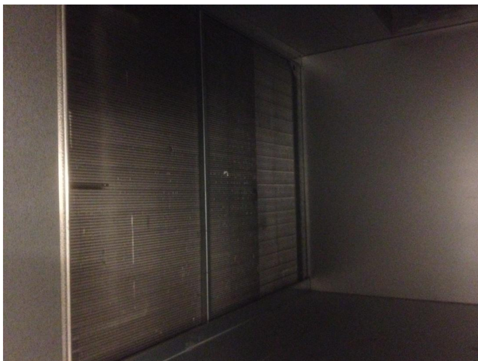
KUVA 18. Ilmanvaihtokoneessa sijaitseva lämmityspatteri, jonka lamellien kunto tarkastettiin
