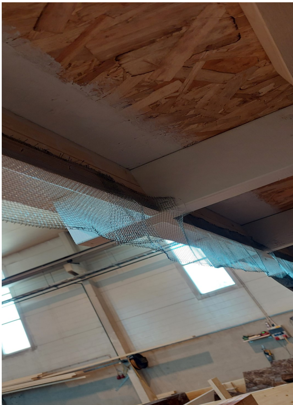
Kuva 13. Räystään alapinta, jossa hyönteisverkko, Jari Mononen, Seikatin tehdas, 2022.
