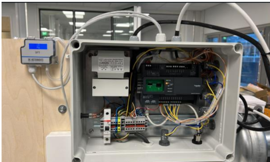
KUVA 20 Tulopuhallin johdotettuna (Puustinen, Tulopuhallin johdotettuna, 2022)
