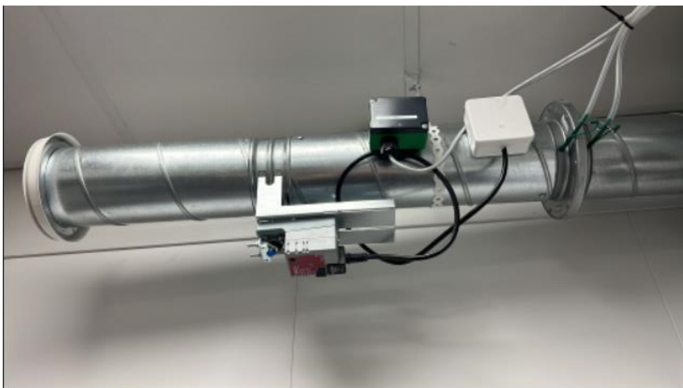
KUVA 25 Kuutio IV-koneen lämpötila-anturi, iris-pelti ja peltimoottori (Puustinen, IV-koneen lämpötila-anturi, irispelti ja peltimoottori, 2022).
