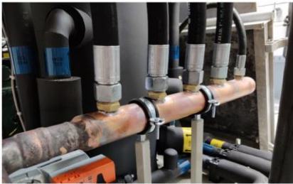
Hyvin tehty ja tuettu varoventtien puhallusputkien kokoojaputki
