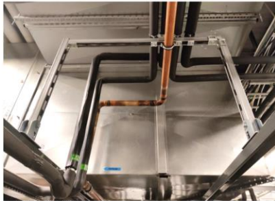
Hyvin tehty putkien kannakointi Hilti-hyllylä
