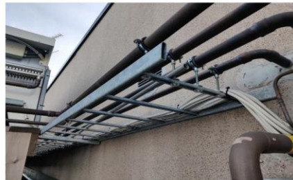
Mallikuva 16. Kaasunjäähdyttimen linjojen hyllynä joko sinkitty rautahylly tai pystyhylly. Kannakointi esim. Mupro-kannakkeilla
