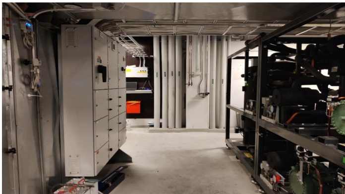
Mallikuva 9. Koneikon ja kalustesähkökeskuksen eteen täytyy jättää min. 800mm vapaata tilaa
