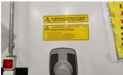
Mallikuva 31. Kylmähuoneen varoitustarrat
