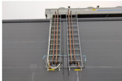
Kaasunjäähdyttimen putkistolinjan kannakointi sinkityllä rautahyllyllä
