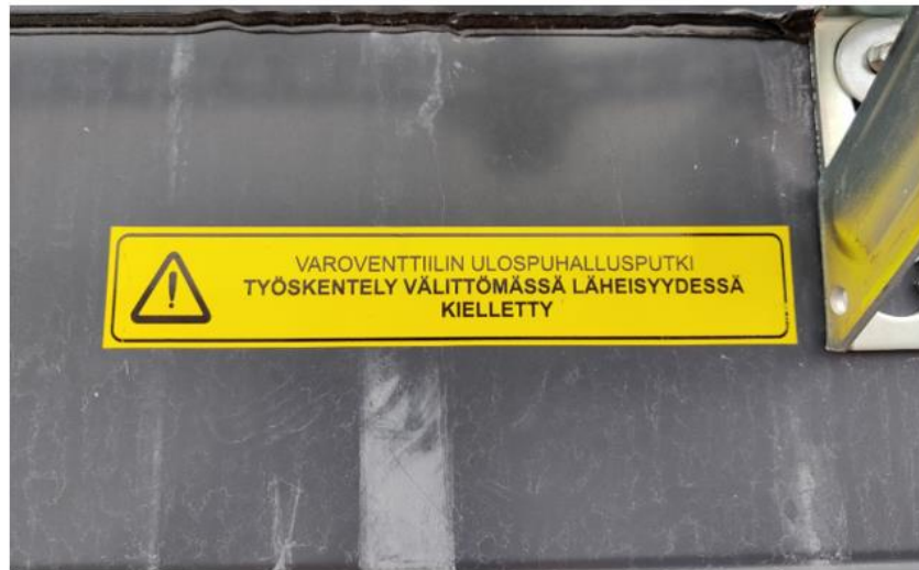
Mallikuva 35. Varoventtiilin ulospuhallusputken varoitustarra
