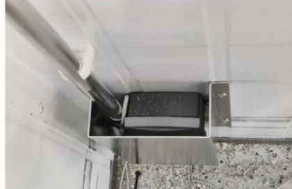
Kaasunhaistelijän johdotus JAPP-suojaputken sisällä samassa linjassa CO2 -hälytysvilkun kanssa
