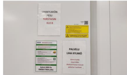
Mallikuva 32. Kylmähuoneen varoitustarrat
