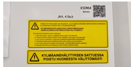
Mallikuva 33. Kylmähuoneen varoitustarrat
