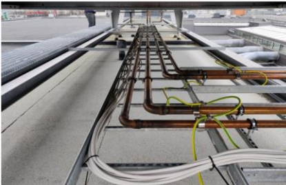
Kaasunjäähdyttimen putkiston mallikas asennus
