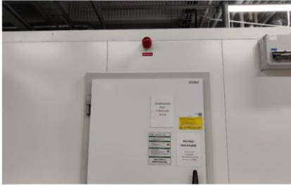
CO2 -hälytysviilku huoneen ulkopuolella selkeällä näkyvällä sijainnilla
