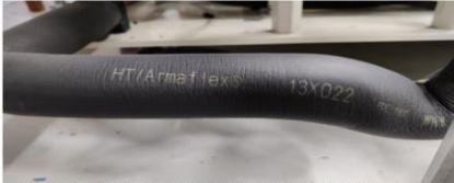
Mallikuva 15. Kuumakaasu linjat eristetään sisätilojen osalta HT 13mm eristeellä. HUOM! Palovammariskin pienentämiseksi putkisto tulee eristää myös silloin, kun se sijaitsee sellaisessa paikassa, jossa putkistoon voidaan olla herkästi kosketuksissa
