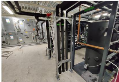
Hilti-hyllylän käyttö putkien kannakoinnissa
