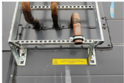
Varoentiliin ulospuhallusputki. (poisto sininen teippi)
