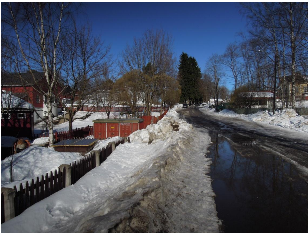
Figur 21. På våren samlas så mycket vatten att det är svårt att ta sig fram till fots. Översvämningsrutt fungerar inte. På sommaren samlas regnvatten vid kullerstensbeläggningen.
