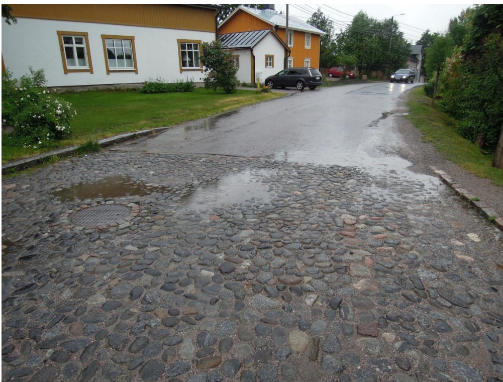
Figur 23. Korsningen mellan Tunnbindarebacken och Gamla Kungsvägen samlar åt sig en del dagvatten vid störtegn.
