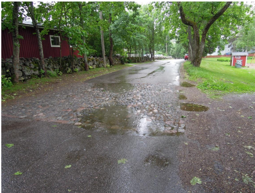
Figur 18. Dagvatten samlas i farthindret vid Wirens park.
