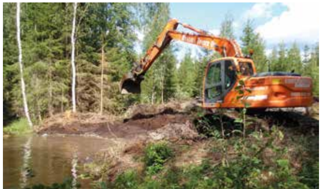
Kuva 8 Laskeutusaltaan kaivua metsäojan varressa. (Petra Korkiakoski)
