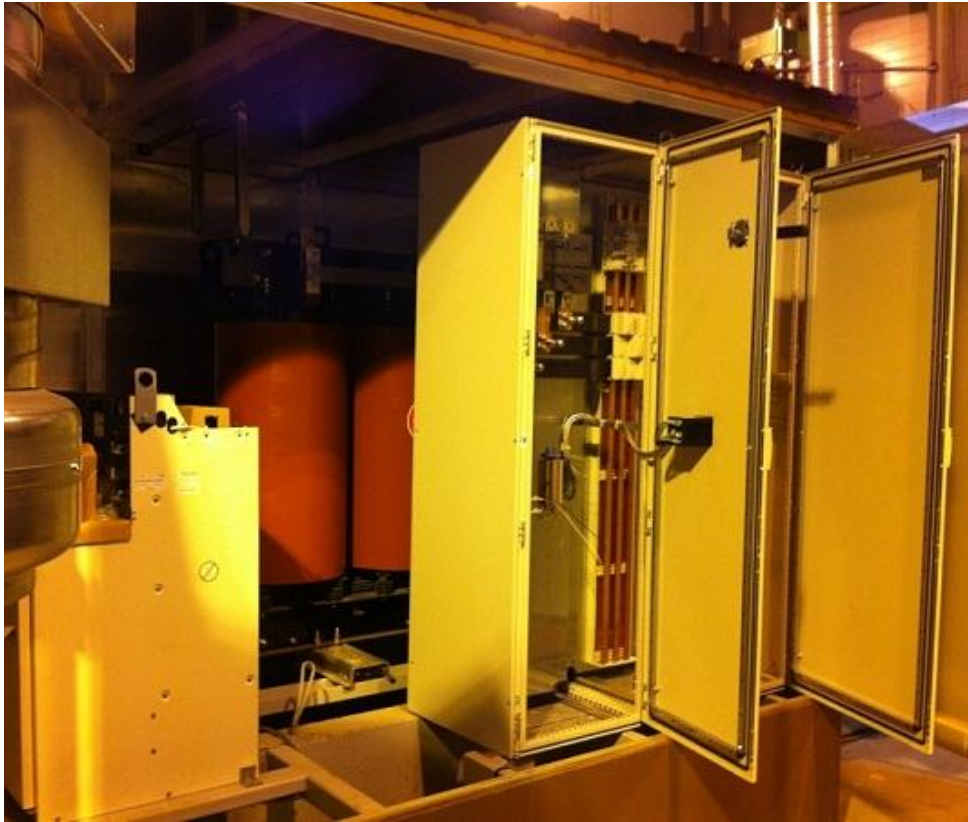
Kuva 5. Koteloitu ja EMC-suojattu muuntajakkeno. (6.)
