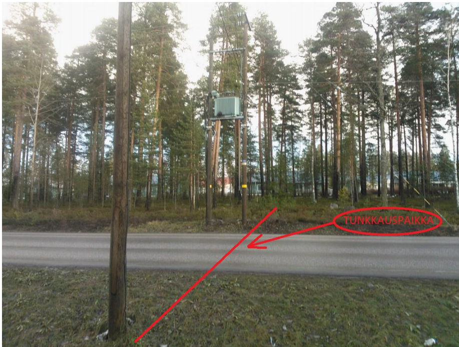
KUVA 1. Kouvolantien alitse tunkataan halkaisijaltaan 400mm teräsputki, johon asennetaan putket 2xP140 ja 3xP110 (Jukka Leino 2012.)
