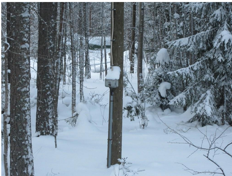
KUVA 3. Liittymän päävarokekotelo pylväässä (Jukka Leino 2012.)
