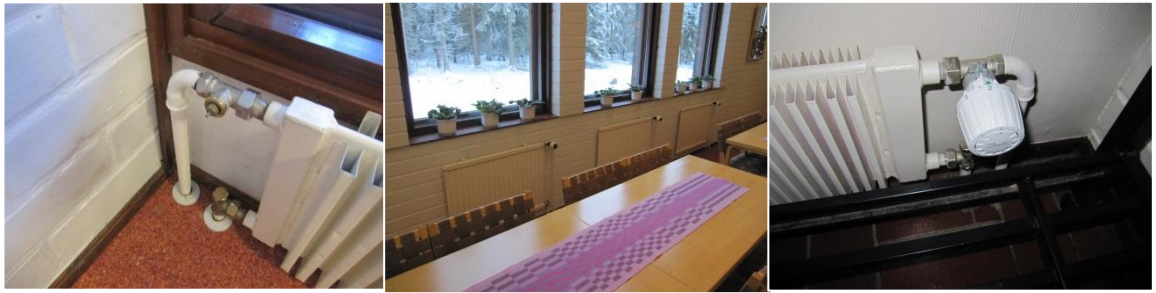
Kuva 15. Seurakuntatalon lämpöpattereiden termostaattisissa patteriventtiileissä on paljon ikä/laatu vaihtelua
