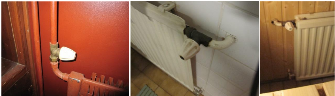
Kuva 16. Asunnon patteriventtiilit ovat jumissa ja hapettuneita
