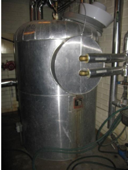
Kuva 6. Lämminvesivaraajassa on eristyshäviötä
