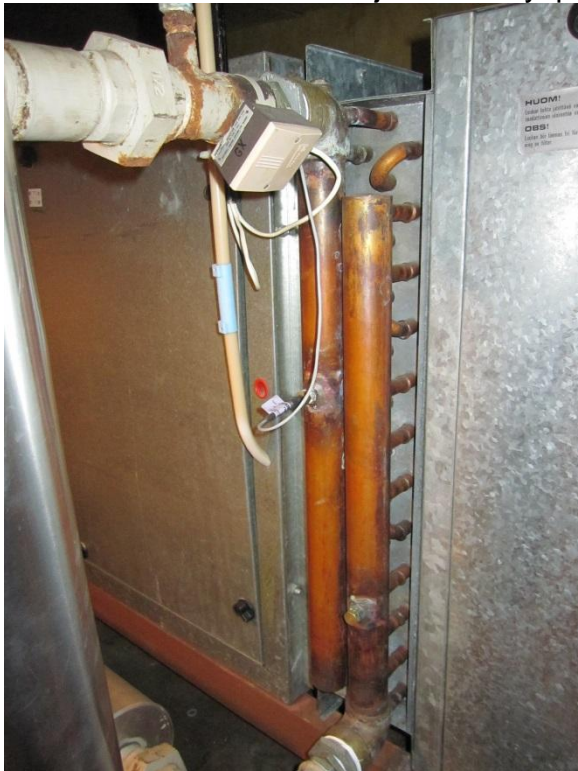
Kuva 17. Tuloilmakone 2. jälkilämmityspatterin liitokset ovat hapettuneita
