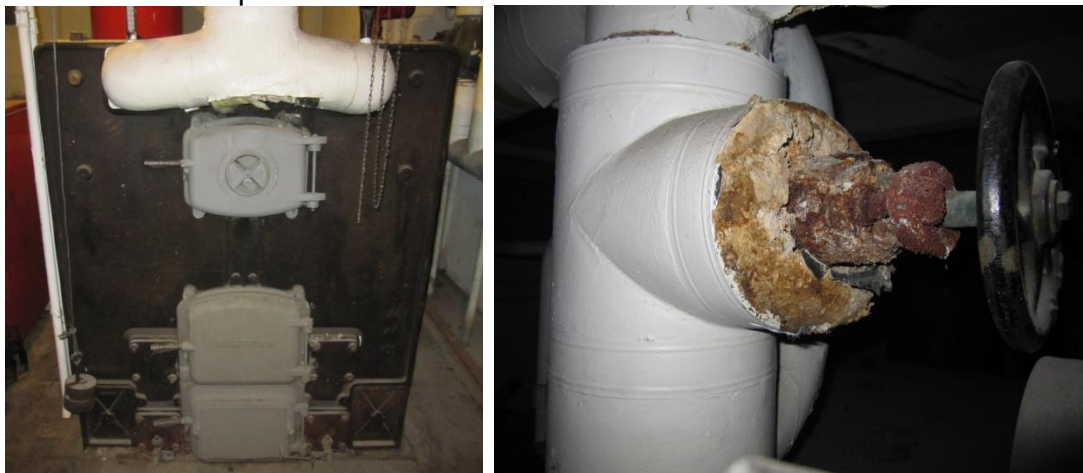
Kuva 3. Vanhan puukattilan kautta kiertää kuuma vesi turhaan
