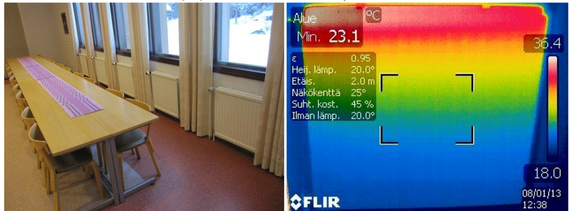
Kuva 13. Sali 1. kaksi lämpöpatteria oli alhaalta kylmiä
