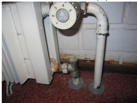
Kuva 14. Kerhuhuoneen lämpöpatterin liitoskohdat ovat hapettuneet
