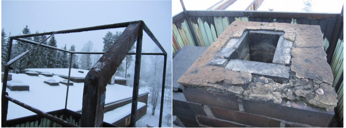
Kuva 5. Savupiipun pää on rapautunut ja tikkaiden yläpää ruostunut pahoin
