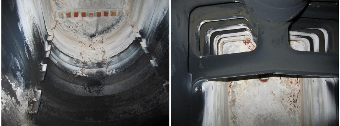
Kuva 3. Öljykattilan tulipesä on paikoin syöpynyt
